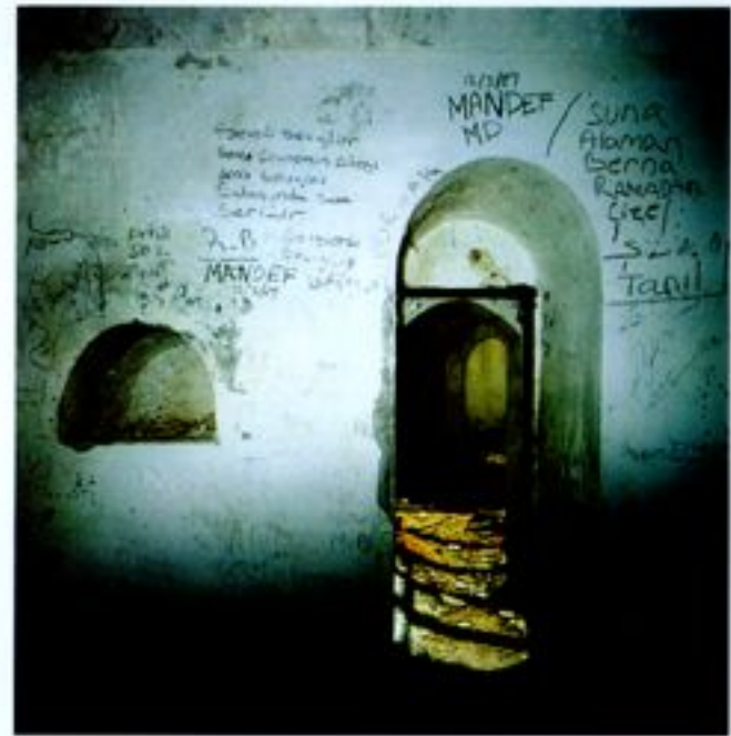
Η σημερινή κατάσταση του Αρμενομονάστηρου είναι άθλια. Οφείλεται στην εγκατάλειψή του από το 1974 και στους βανδαλισμούς που έχει υποστεί.
