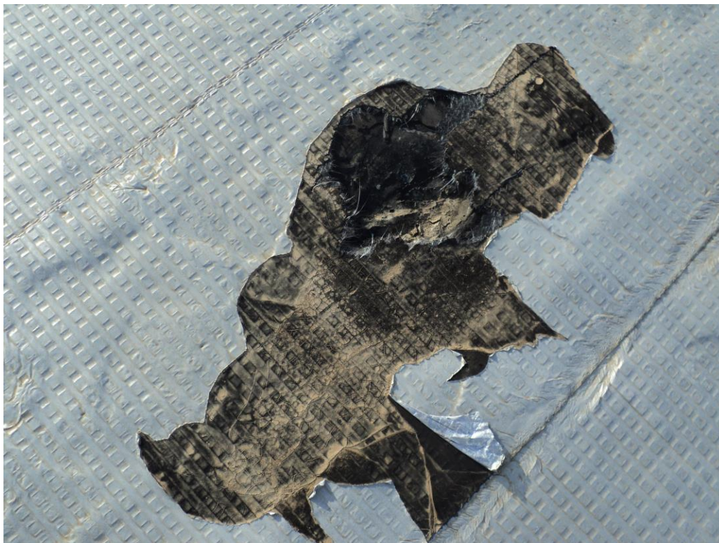
Φωτογραφία 3: Φθορές στον τζαμωτό φεγγίτη της στέγης
