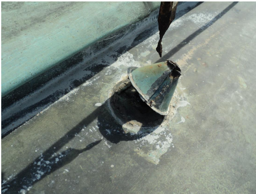
Φωτογραφία 11: Φθορές σε διάφορα σημεία της στέγης
