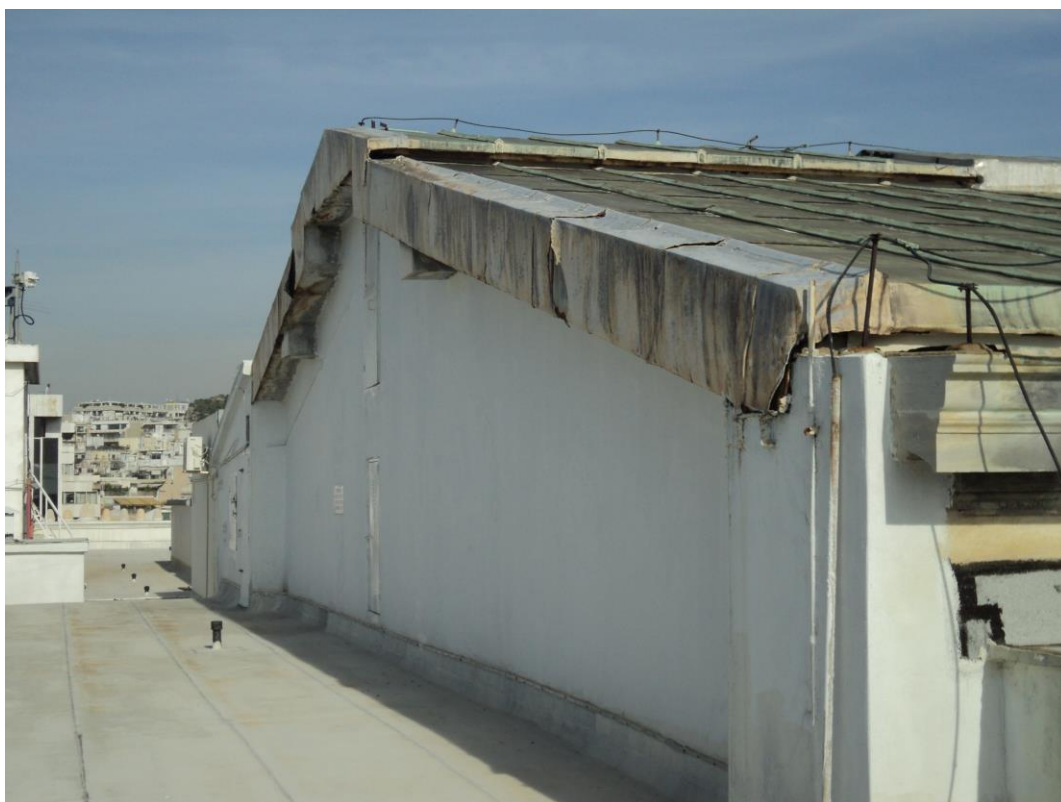
Φωτογραφία 8: Φθορές σε διάφορα σημεία της στέγης
