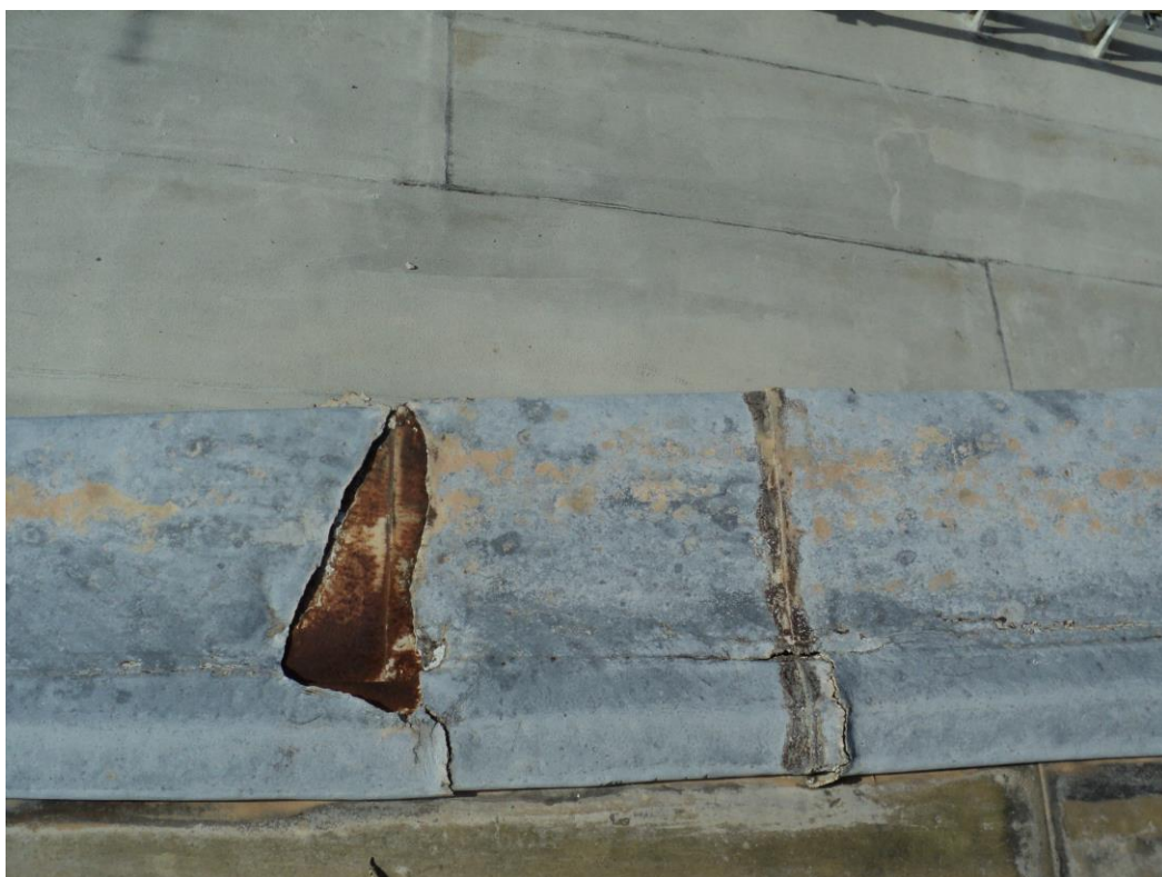
Φωτογραφία 7: Φθορές σε διάφορα σημεία της στέγης
