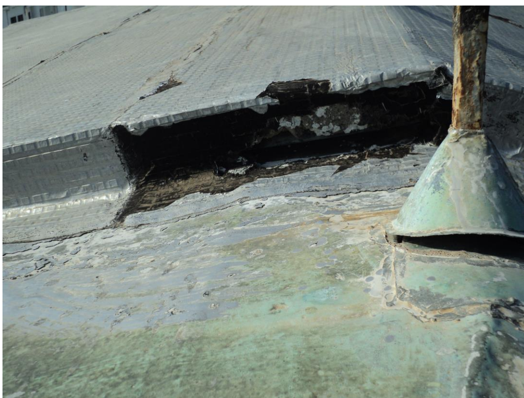
Φωτογραφία 4: Φθορές στον τζαμωτό φεγγίτη της στέγης
