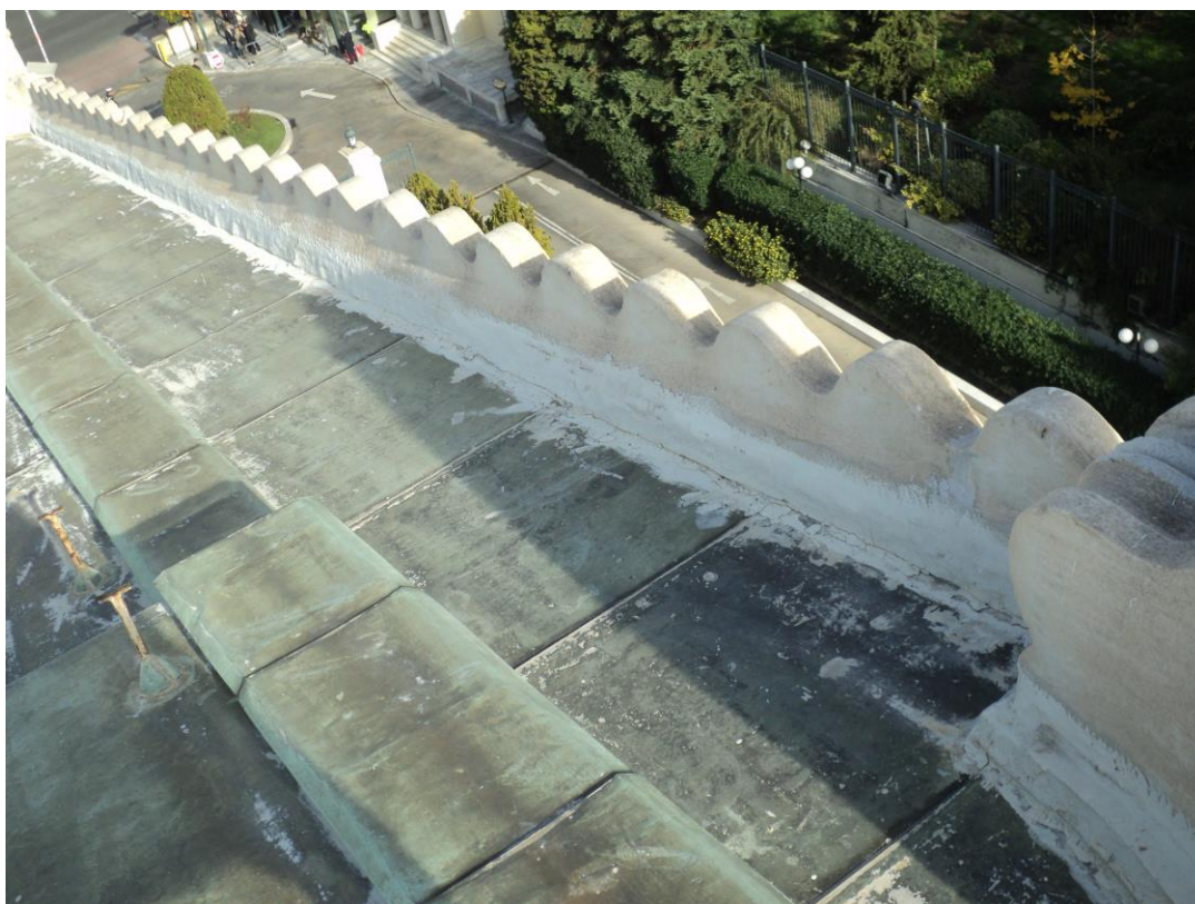
Φωτογραφία 12: Φθορές στο ανατολικό λούκι της στέγης
