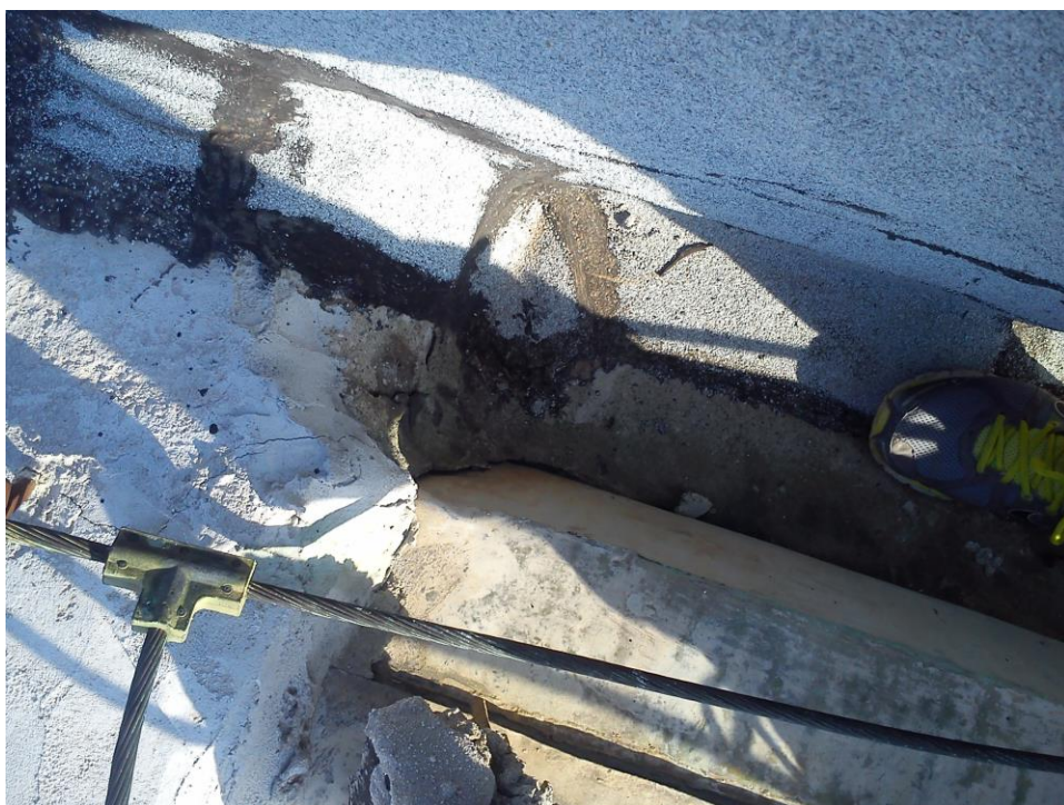
Φωτογραφία 15: Φθορές στο βορινό λούκι της στέγης
