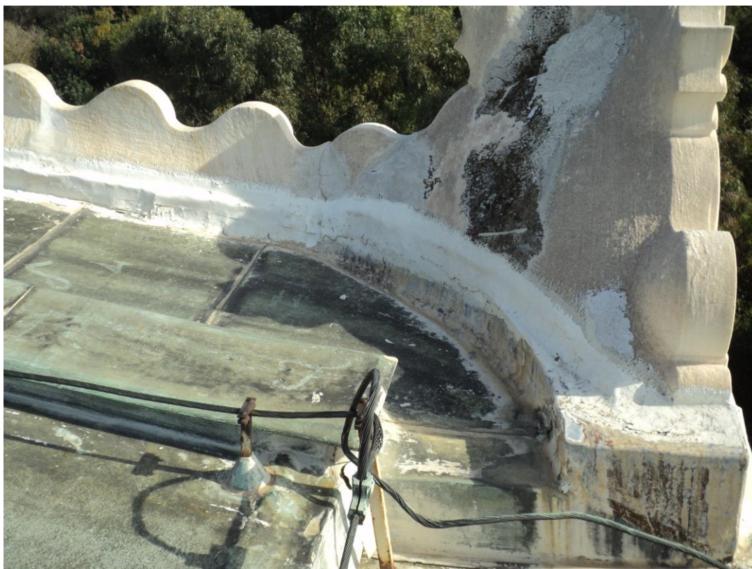
Φωτογραφία 13: Φθορές στο ανατολικό λούκι της στέγης
