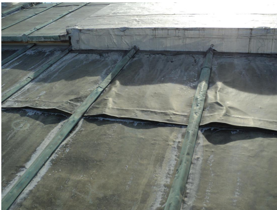
Φωτογραφία 6: Φθορές σε διάφορα σημεία της στέγης
