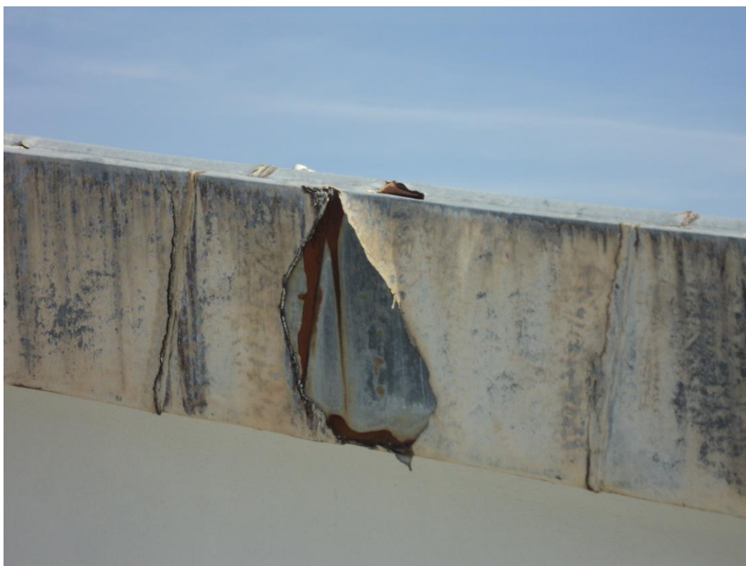
Φωτογραφία 10: Φθορές σε διάφορα σημεία της στέγης
