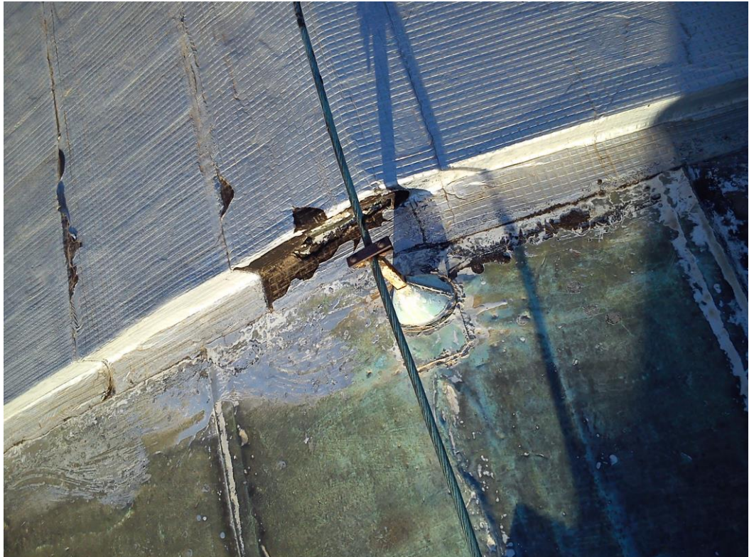
Φωτογραφία 2: Φθορές στον τζαμωτό φεγγίτη της στέγης
