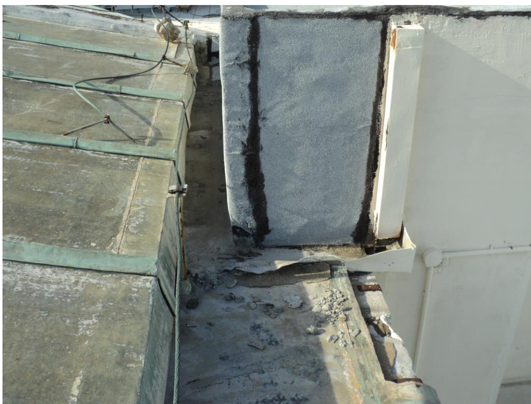
Φωτογραφία 14: Φθορές στο βορινό λούκι της στέγης
