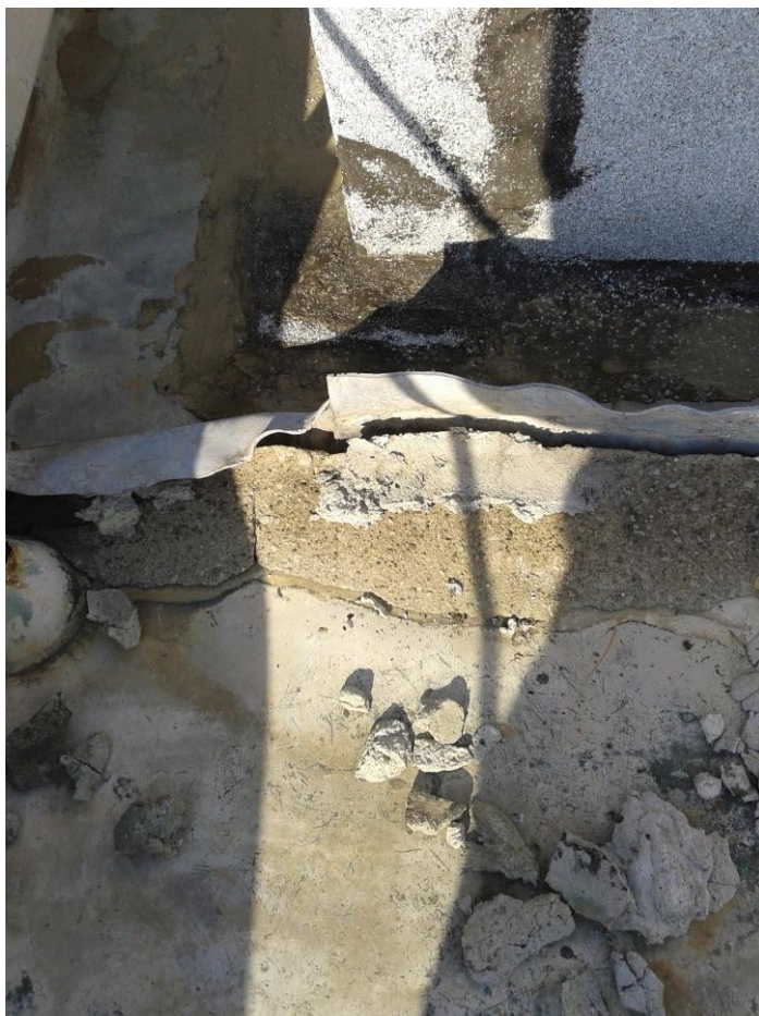
Φωτογραφία 16: Φθορές στο βορινό λούκι της στέγης
