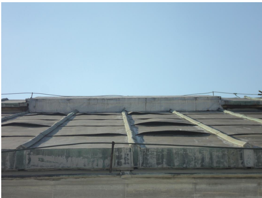
Φωτογραφία 5: Φθορές σε διάφορα σημεία της στέγης
