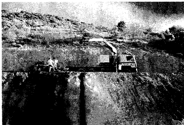
Συνεχίζονται οι διαμαρτυρίες για τα προβλήματα που έχει προκαλέσει σε κατοικημένες περιοχές η κατασκευή του νέου αυτοκινητόδρομου Πατρών-Κορίνθου αλλά και της σιδηροδρομικής κατασκευής
