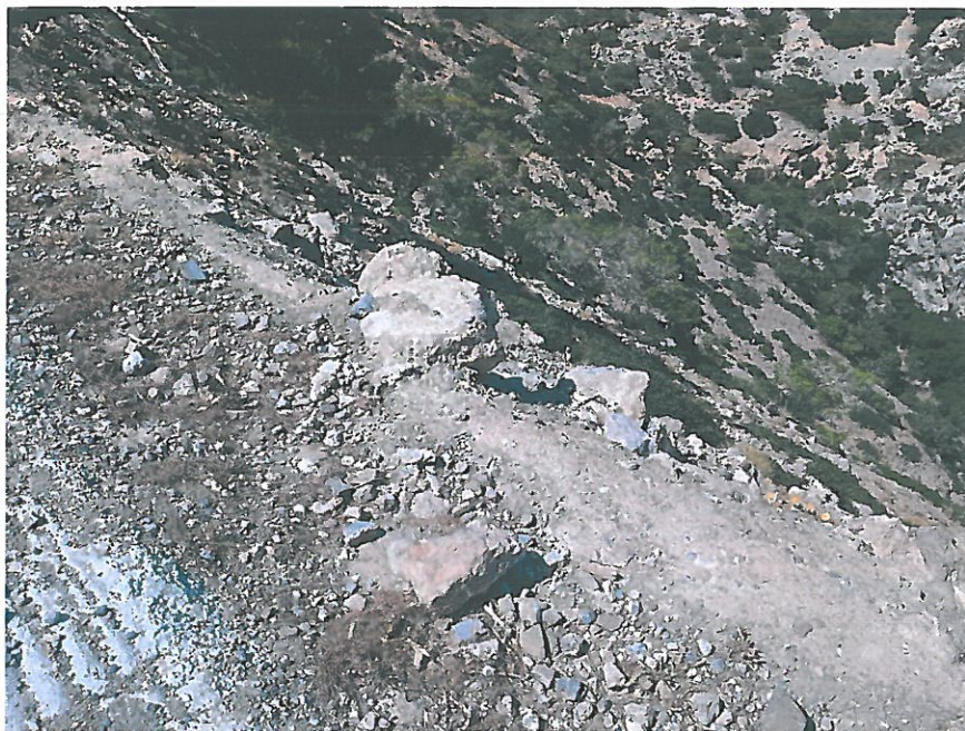
Φωτογραφία Γ3 - Εκτεθειμένο εξωτερικό άκρο του δρόμου σε απότομο πρανές.
