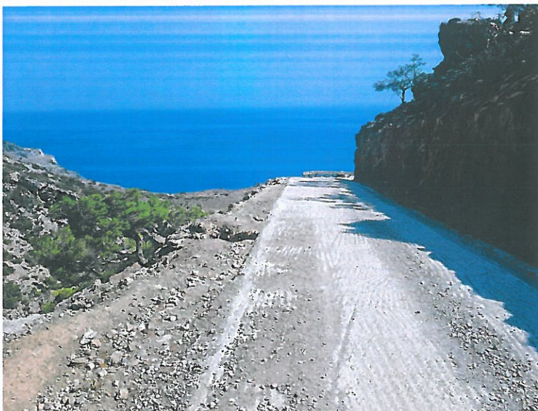
Φωτογραφία Γ1 - Χωματόδρομος σε εκτεθειμένο οδικό τμήμα με απότομο πρηνές.
