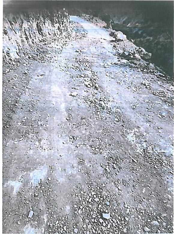
Φωτογραφία Γ8 - Εκτεταμένη φθορά και ανομοιομορφία του χωματόδρομου.
