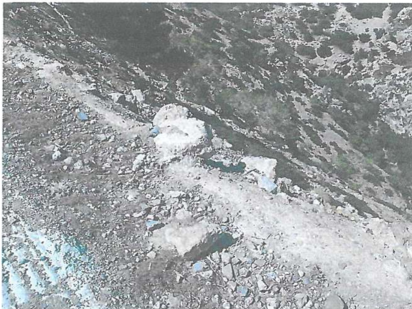
Φωτογραφία Γ3 - Εκτεθειμένο εξωτερικό άκρο του δρόμου σε απότομο πρηνές.
