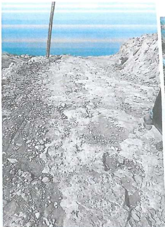
Φωτογραφία Γ6 - Βραχώδεις εξάρσεις και ανωμαλίες στο οδόστρωμα.
