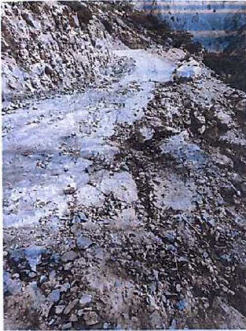
Φωτογραφία Γ5 - Έντονες φθορές και διάβρωση της επιφάνειας του δρόμου.
