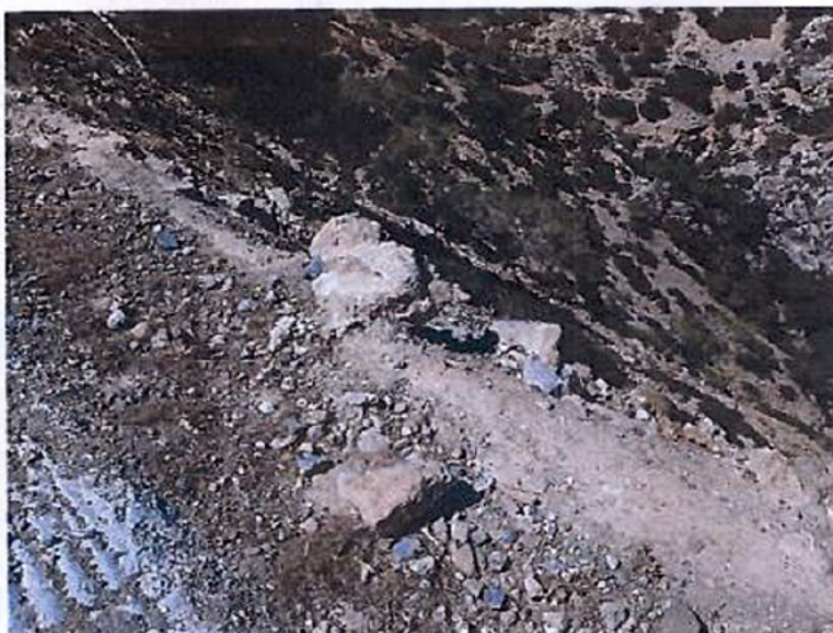
Φωτογραφία Γ3 - Εκτεθειμένο εξωτερικό άκρο του δρόμου σε απότομο πριανές.
