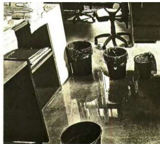
Κουβάδες τοποθετημένοι κάτω από ταβάνια που στάζουν
