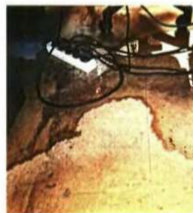
► Σε ορισμένα σημεία, οι δικαστικοί υπάλληλοι εργάζονται δίπλα σε καλώδια και ηλεκτρολογικές εγκαταστάσεις εκτεθειμένες στην υγρασία
