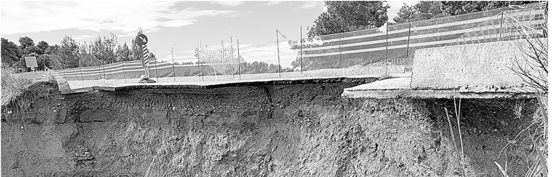
Δύο έγγραφα σε υπουργεία και περιφέρεια αντίστοιχα, έστειλαν οι δήμοι της Ηλείας, ζητώντας την άμεση αποκατάσταση του δρόμου
