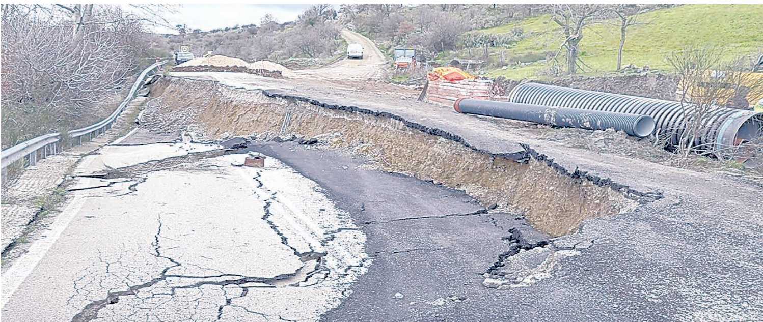
Το οδόστρωμα έχει υποχωρήσει κατά τουλάχιστον τρία μέτρα. «κόβοντας» κυριολεκτικά στα δύο την εθνική οδό και διακόπτοντας τη σύνδεση μεταξύ περιοχών της Ηλείας, της Αχαΐας και της Αρκαδίας
