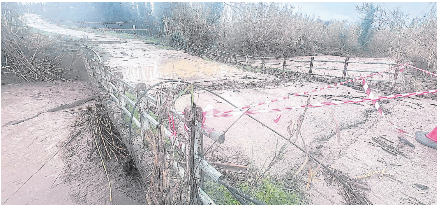
Η ορμητικότητα του χειμάρρου κατέστρεψε τη γέφυρα, καθιστώντας τη διέλευση οχημάτων από το σημείο απαγορευτική
