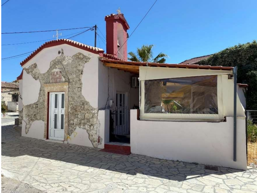
Ιερός ναός Αγίου Ιωάννη μετά το σεισμό και ο χώρος με την «πέργκολα».
