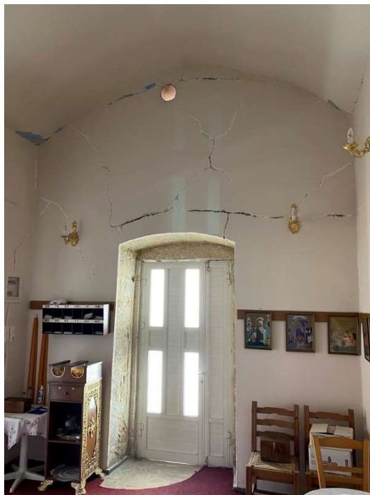
Βλάβες στο εσωτερικό
