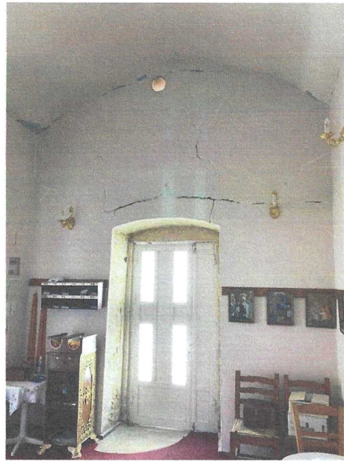
Βλάβες στο εσωτερικό
