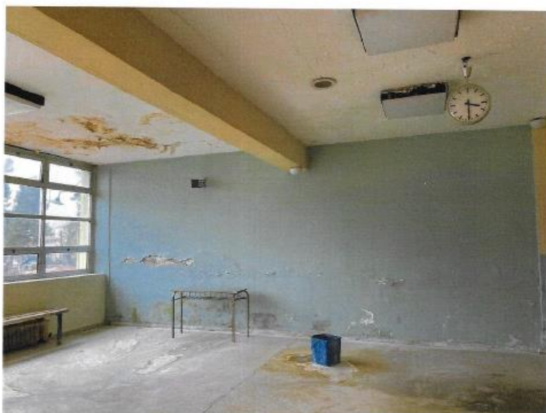
Εικ.3: Εισροή όμβριων υδάτων (φθορές επιχρισμάτων και δαπέδων)
