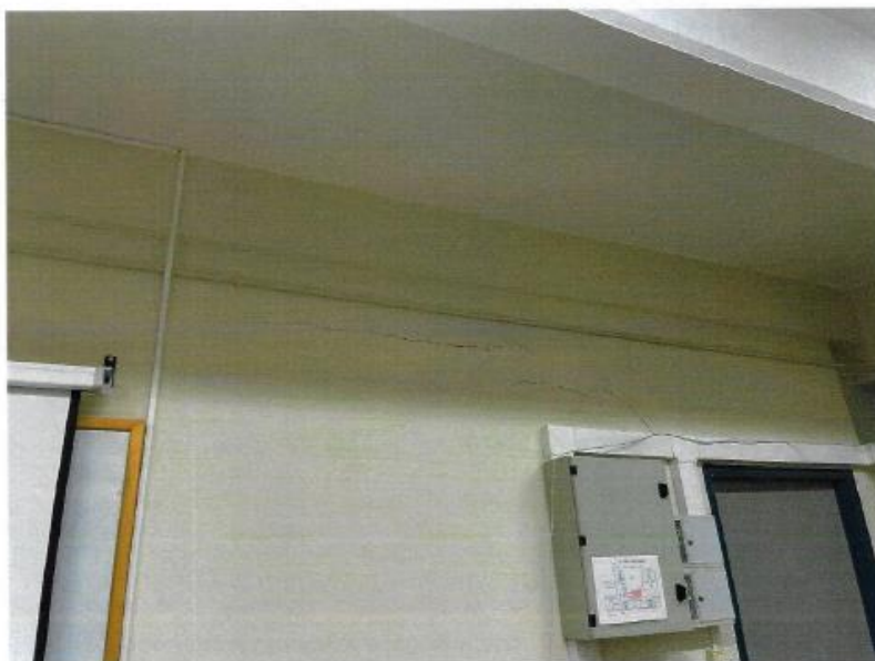
Εικ. 2: Οριζόντιες ρωγμές τοιχοποιίας
