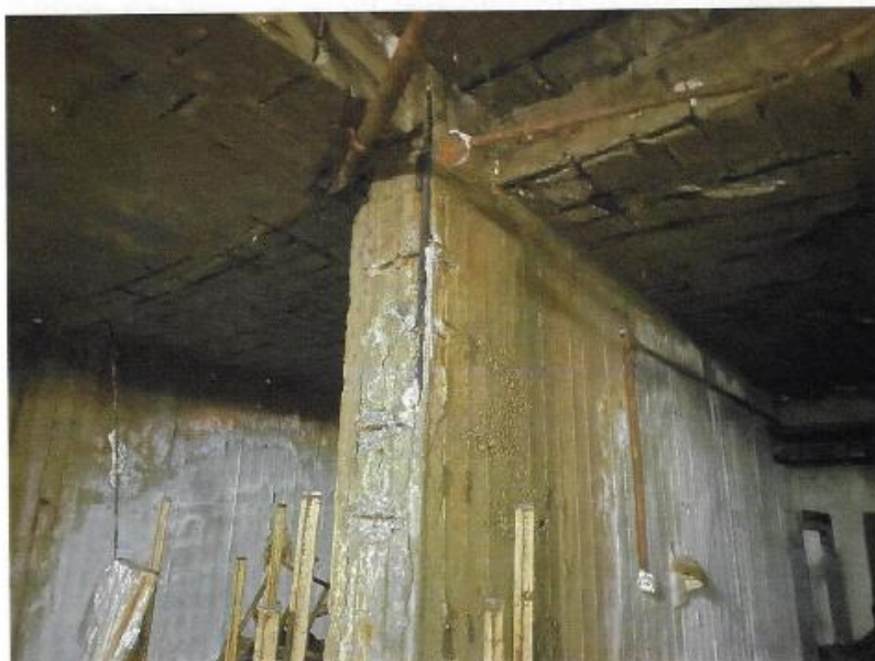
Εικ.7: Διάβρωση σκυροδέματος υπογείου και διάβρωση οπλισμών
