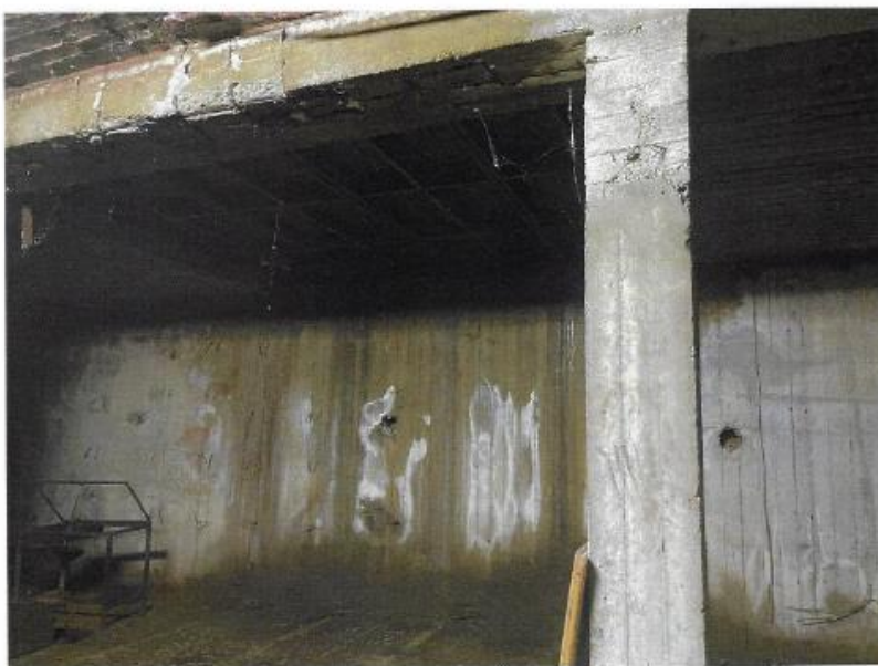
Εικ.6: Διάβρωση σκυροδέματος υπογείου και διάβρωση οπλισμών
