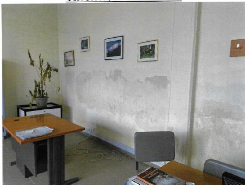
Εικ. 1: Αποσάθρωση επιχρισμάτων και ανάπτυξη μυκήτων
