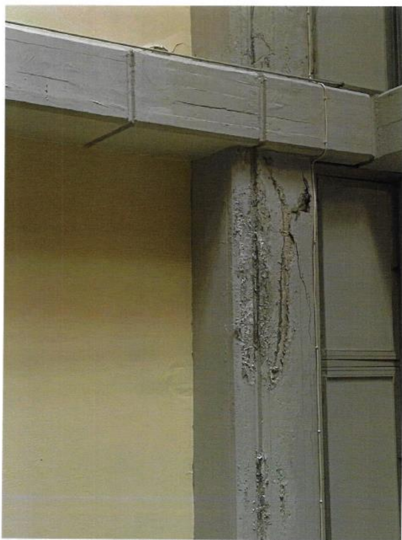
Εικ.5: Αποσάθρωση σκυροδέματος και αποκάλυψη οπλισμών
