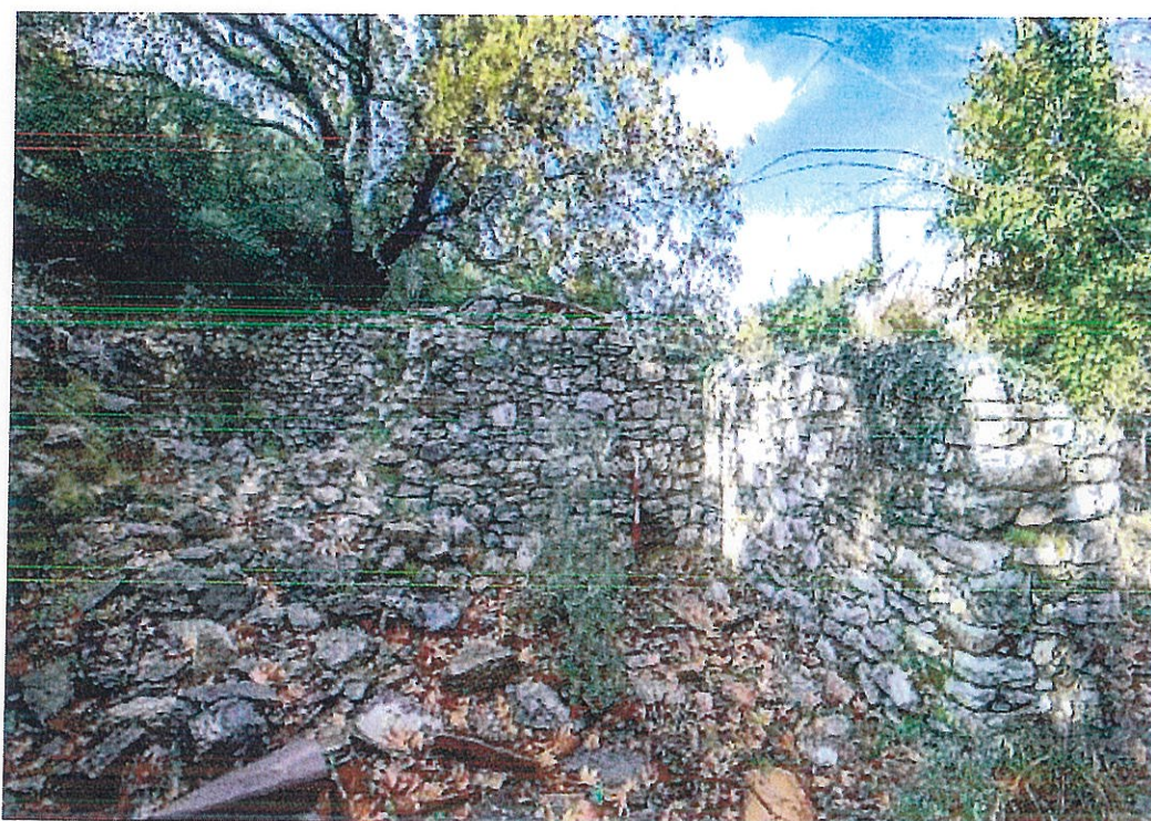
Εικ.7: Το Εσωτερικό του κτηρίου Α, όπου έχει πέσει η οροφή (αρχείο Κων/νου Τζιαμπάση)
