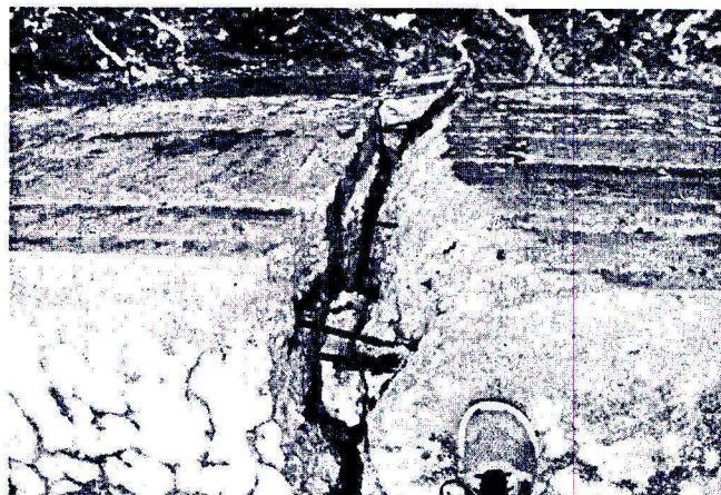
31/01/2019 - Κατακόρυφη ρωγμή στα γωνιακά μπλόκια
