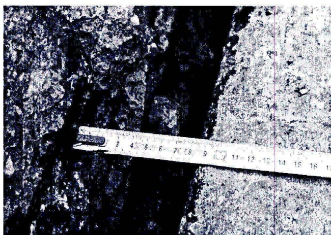
31/01/2019 - Πάχος ρωγμής 9cm
