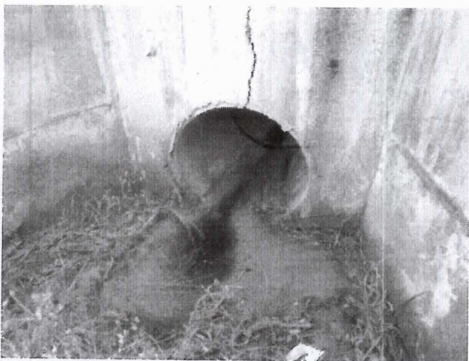
Εικόνα 7. Φωτογραφία του αγωγού που εξέβαλλε υγρό στο φρεάτιο
