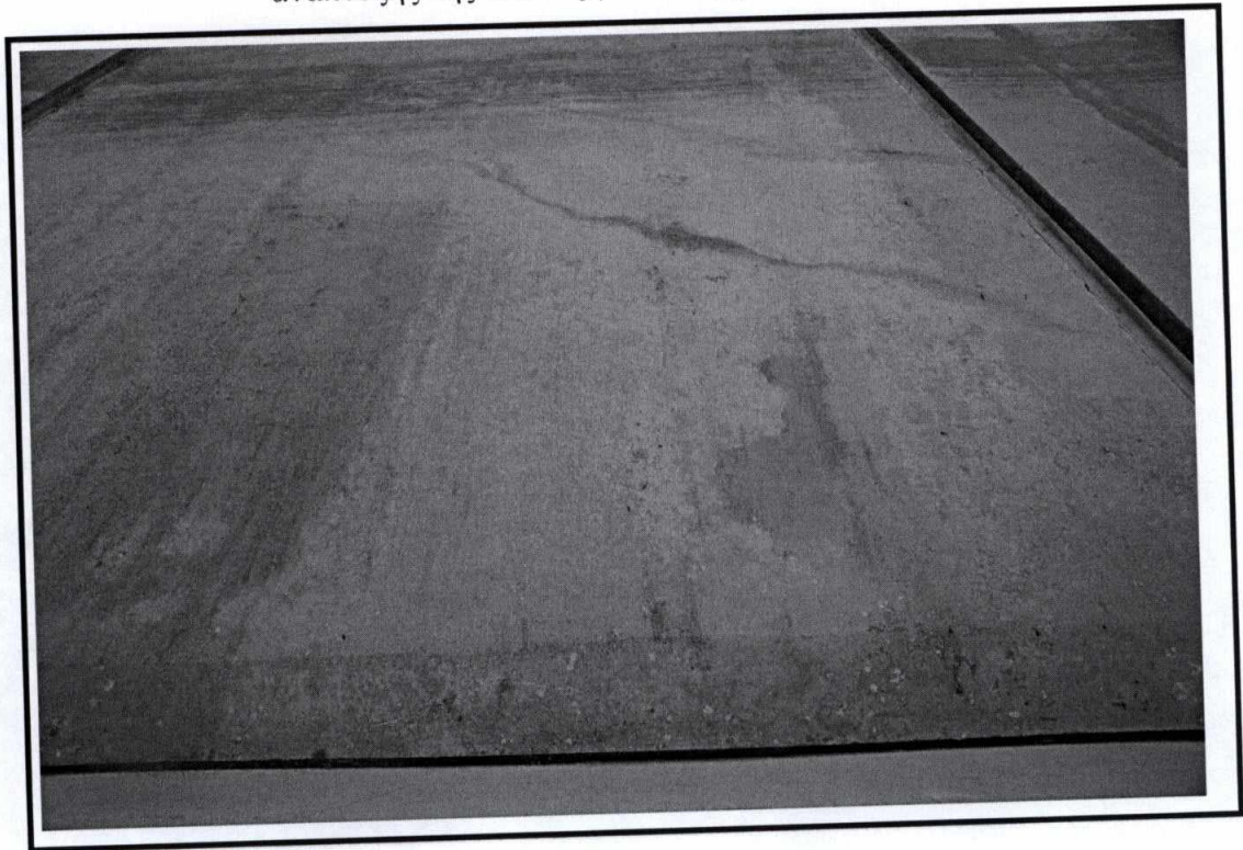
Φωτογραφία 9. Διαγώνιες ρωγμές , ως προς την επιμήκη διεύθυνση ανάπτυξης της πλάκας μπετού ( φάτνωμα 2)
