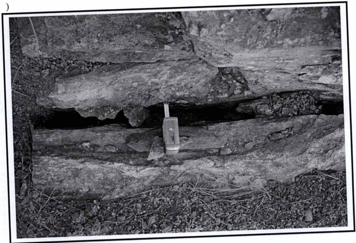
Φωτογραφία 3. Ανοικτές διαρρήξεις στο νότιο πρανές του ρέματος (πόδα φράγματος
