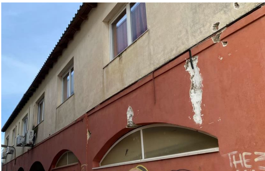
Φθορές σε εξωτερική τοιχοποιία
