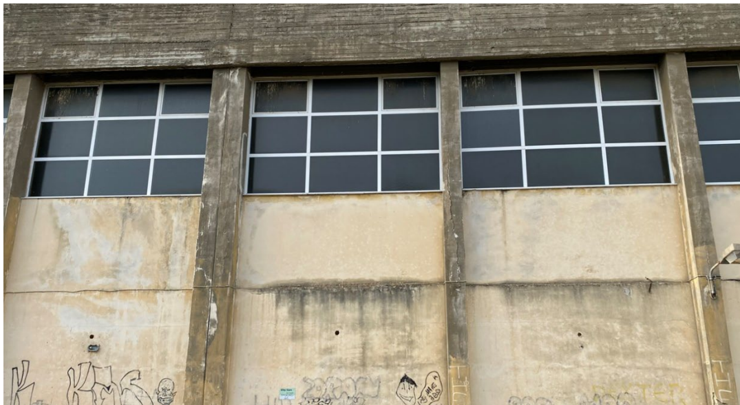
Εξωτερικές ρηγματώσεις στις κολώνες
