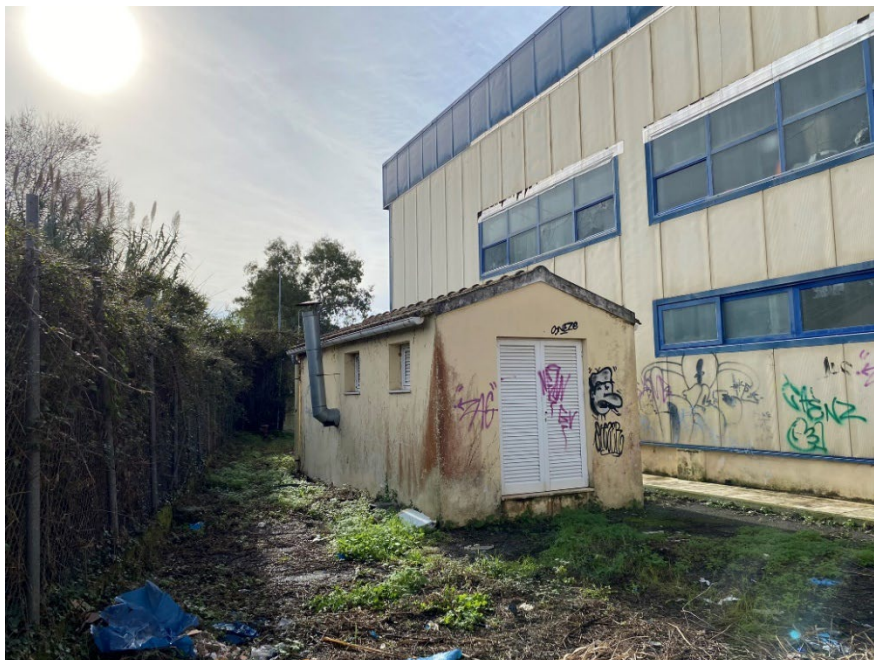
Άποψη του λεβητοστασίου
