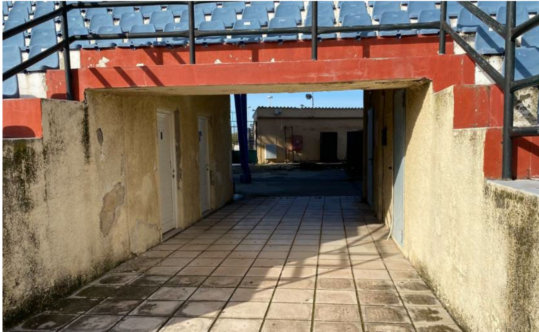
Στοιχεία εξάρσης μούχλας σε εξωτερικές τοιχοποιίες και φθορές σε εξωτερικούς σοβάδες
