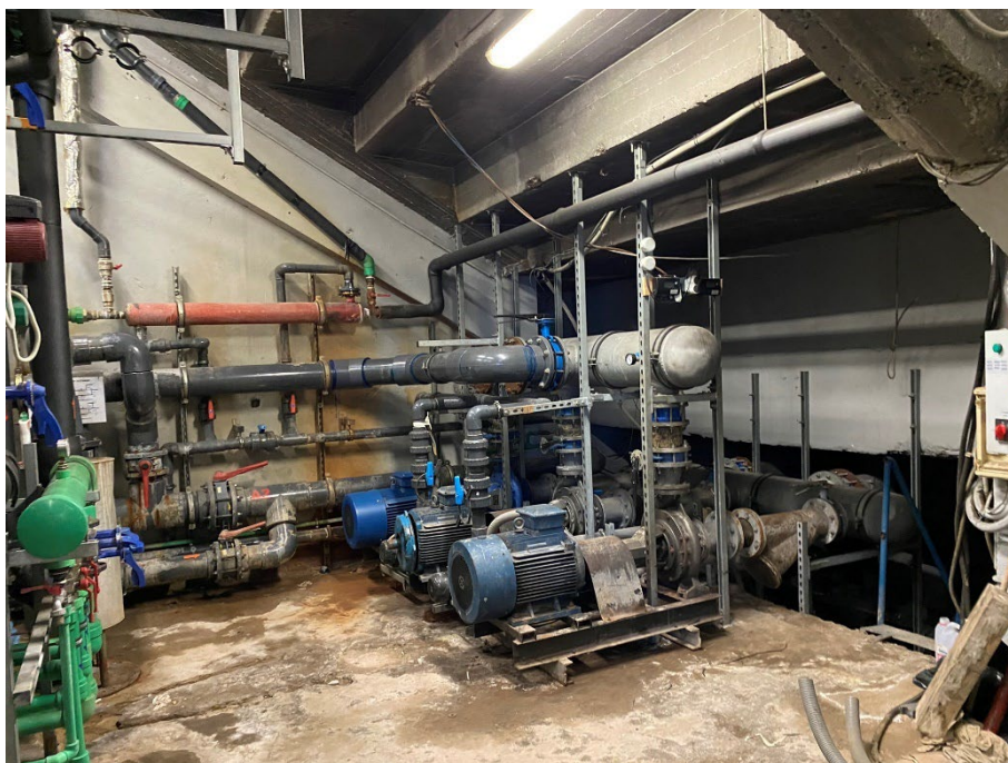
Άποψη μηχανολογικού εξοπλισμού
