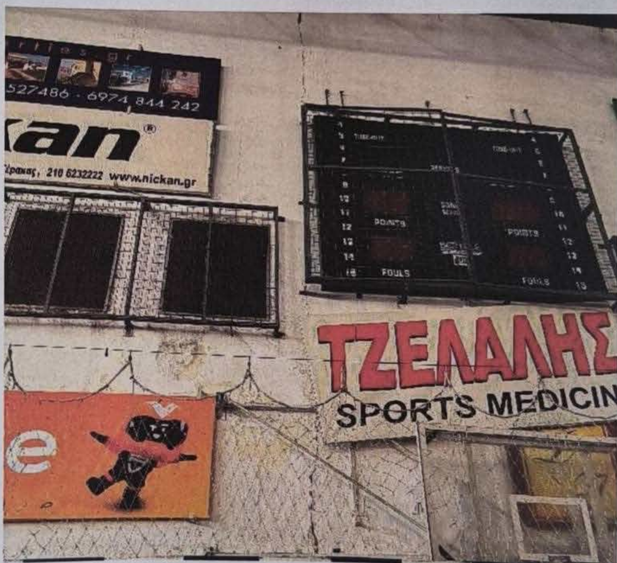
Φωτογραφία 11. Υγρασίες στο τμήμα 5
