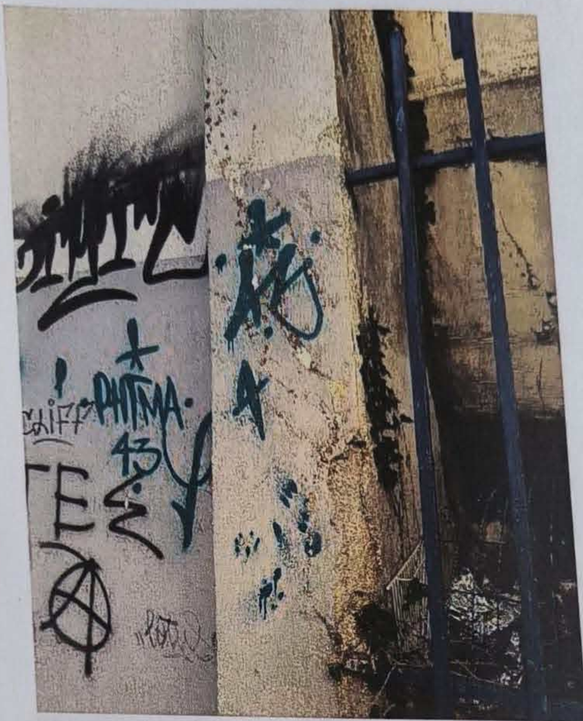
Φωτογραφία 5. Φθορές εξωτερικά υποστυλώματος του τμήματος 4
