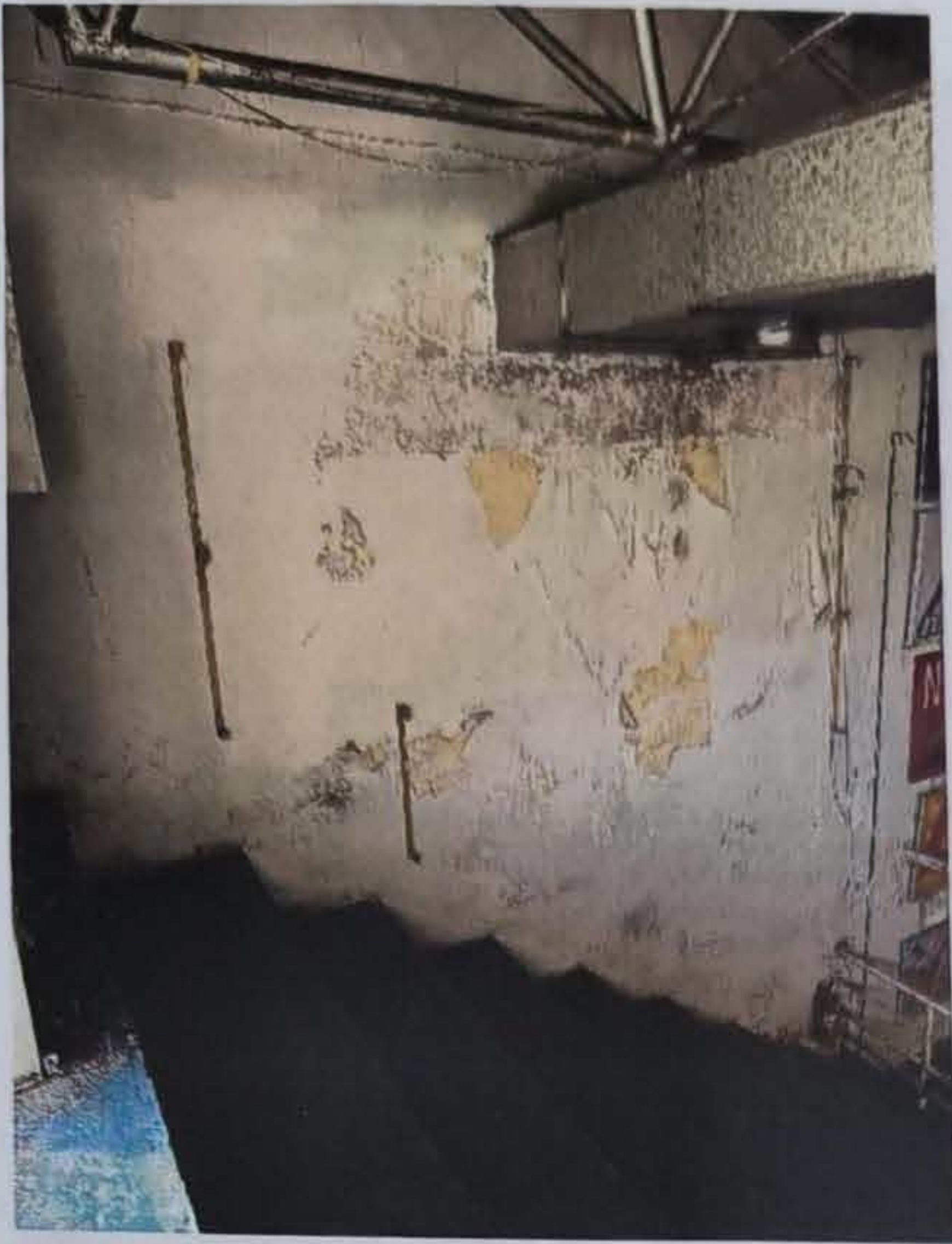
Φωτογραφία 1. Υγρασίες στο τμήμα 5
