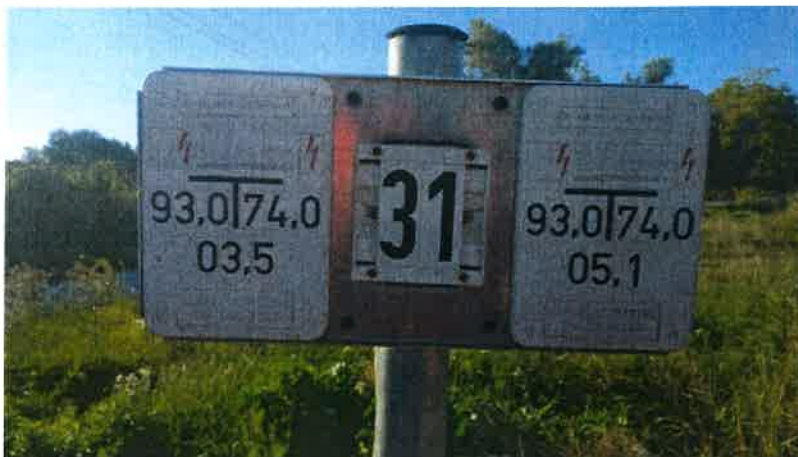
Εικόνα 1: Φωτογραφία κατά τη διάρκεια διεξαγωγής μέτρησης του μαγνητικού πεδίου στην πινακίδα (31) ένδειξης θέσης καλωδίων (Θέση 2). Η βάση είναι στο σημείο μέτρησης με α/α 4.
