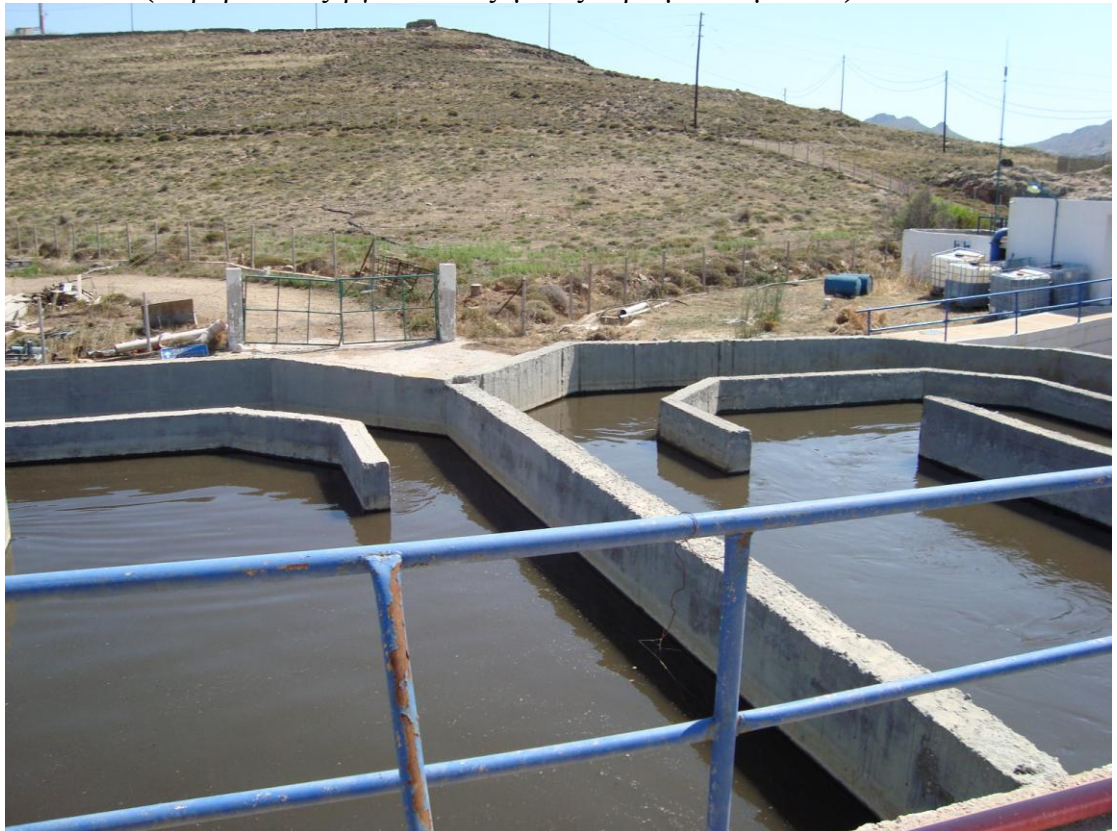
ΦΩΤΟ 8. (Αερόβια επεξεργασία. Δεξαμενές αερισμού λυμάτων.)
