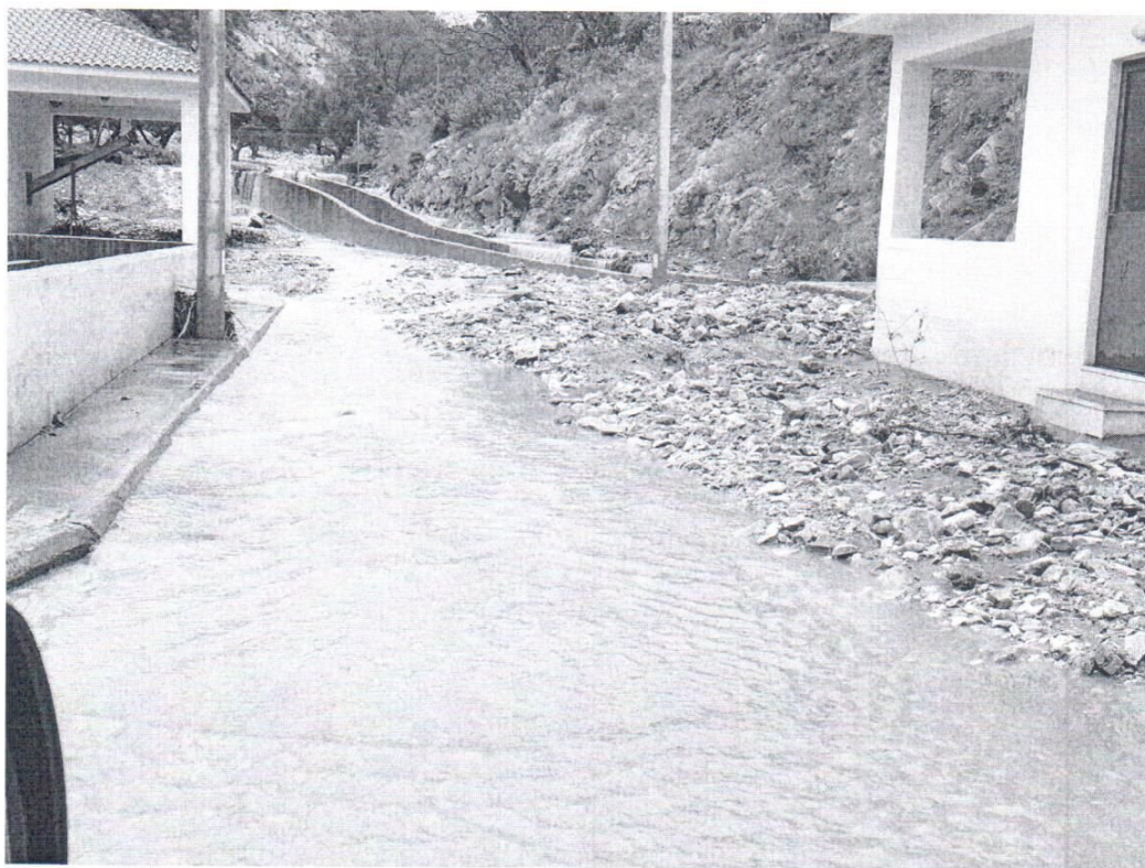
Εικόνα 9- Επιχώσεις με φερτά υλικά υποδομών Δήμου Ξηρομέρου
