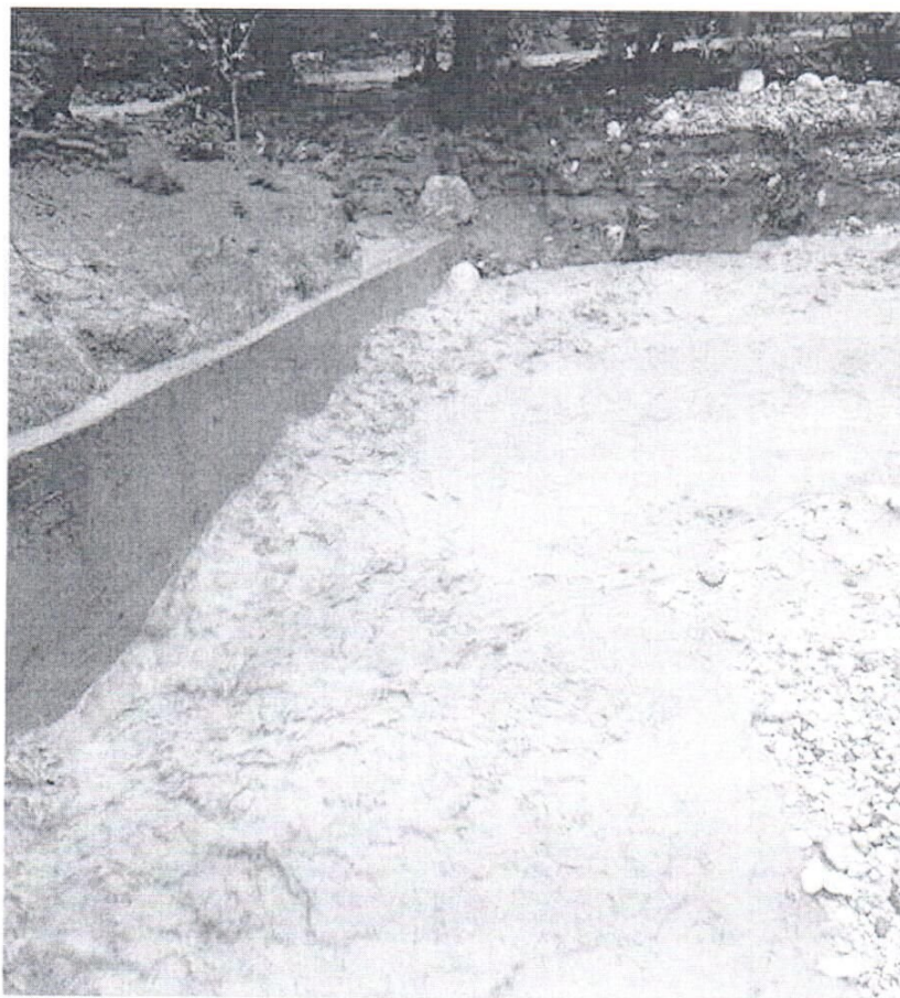
Εικόνα 9- Υπερχείλιση ποταμού στην Τ.Κ. Βάρνακα
