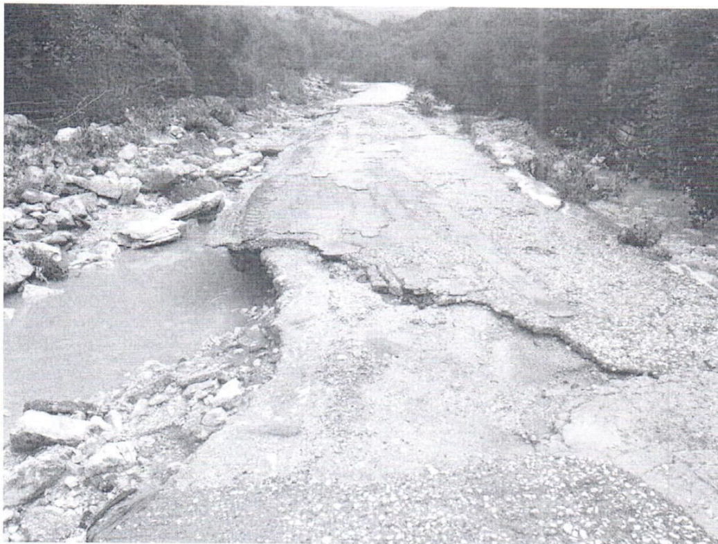
Εικόνα 8- Καταστροφή οδικού δικτύου
