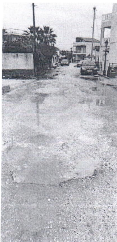
Εικόνα 11- Φθορές στο οδόστρωμα στην Τ.Κ. Μύτικα
