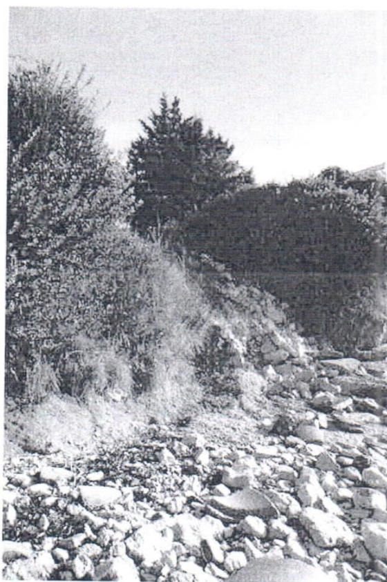
Εικόνα 3- Αγροτική Οδοποιία και καταπτώσεις πρανών στην Τ.Κ. Αστακού
