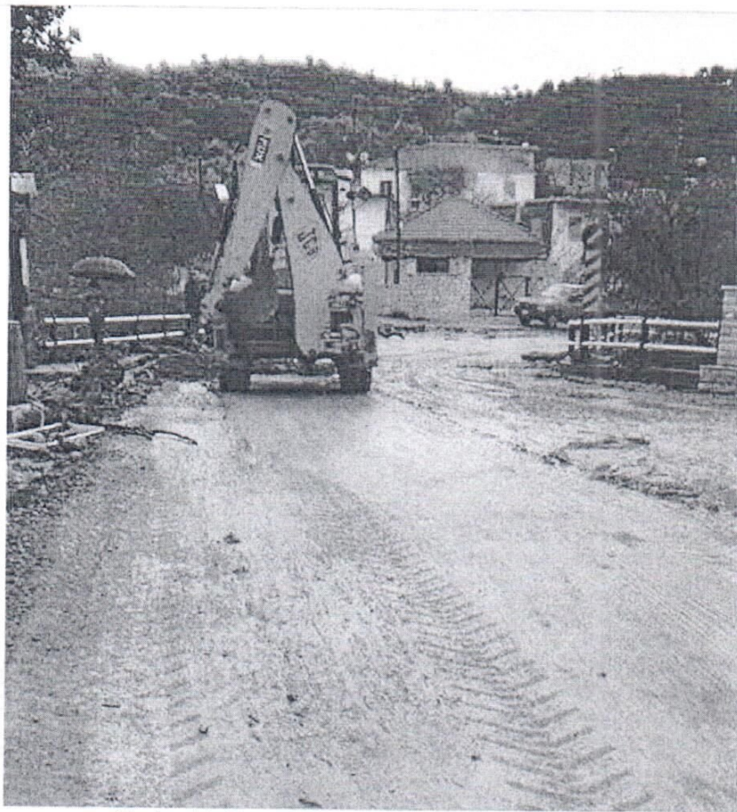
Εικόνα 10- Υπερχείλιση ποταμού στην Τ.Κ. Βάρνακα
