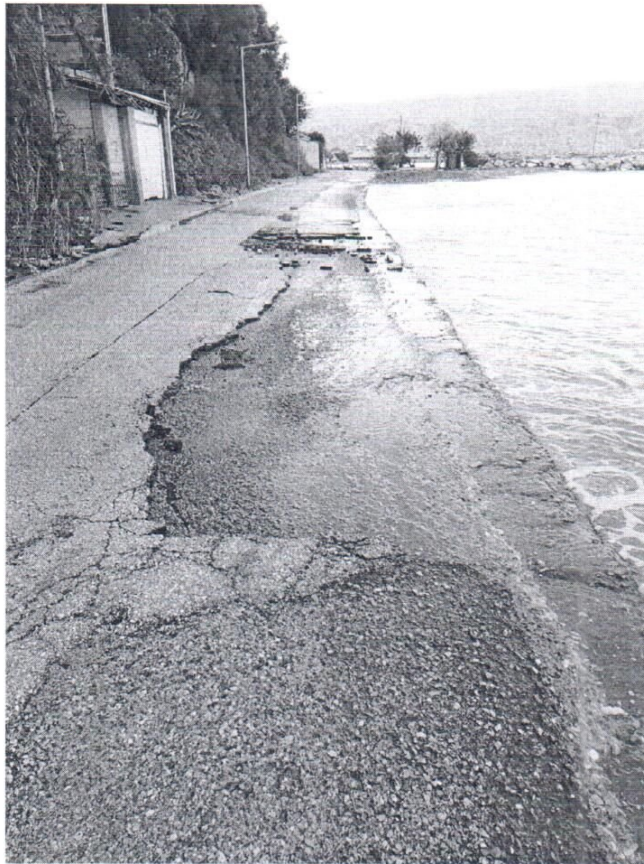
Εικόνα 3- Ζημιές στο λιμάνι Αστακού
