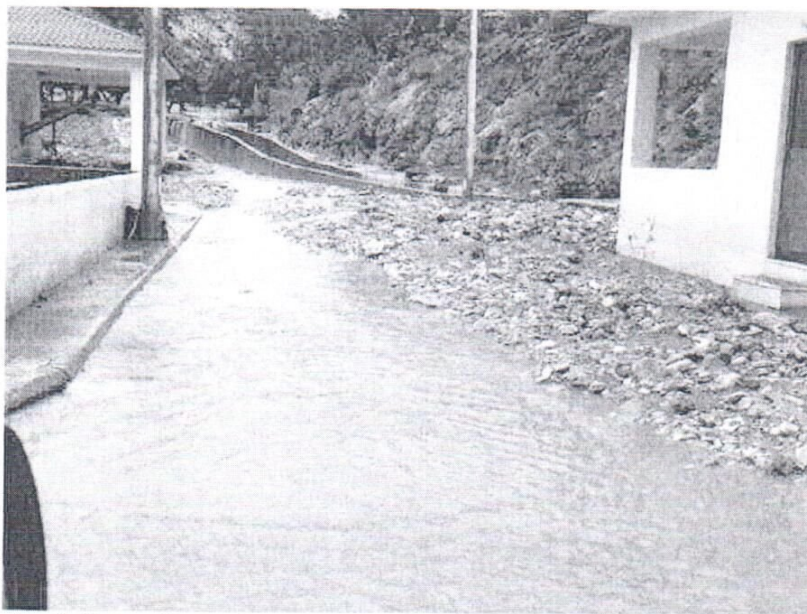
Εικόνα 3- Υπερχειλίση ρέματος και επιχώσεις με φερτά υλικά των ΕΕΛ Αστακού
