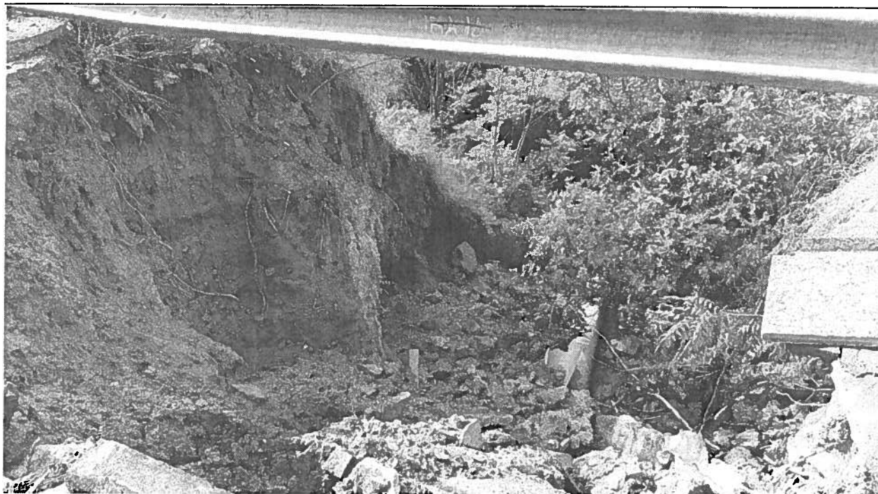
Εικόνα 2.1.9. Αποτυπώνονται κυρίως υλικά του αγωγού απορροής, τμήματος του καταστρώματος και πεζοδρομίου καθώς και του επιχώματος έδρασης, που έχουν αστοχήσει και κατολισθήσει σε τμήμα του ανάντη πρανούς. Τονίζεται ότι η κλίση του ανάντη πρανούς είναι περίπου 4 (κ) : 1 (ο) και η στάθμη όπου αποτυπώνεται στην παρούσα είναι περίπου – 30.0m από το κατάστρωμα.
