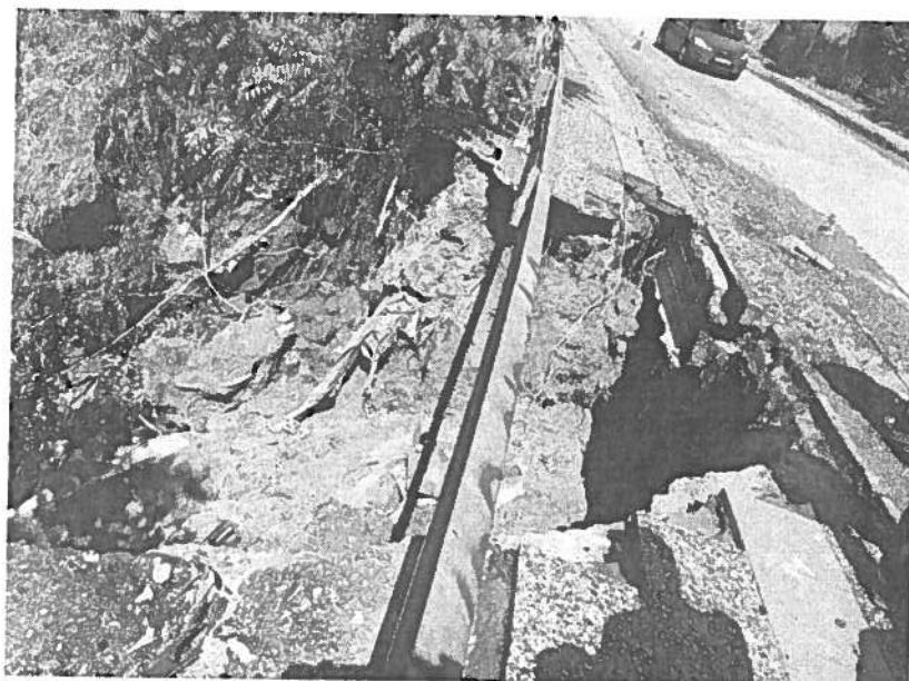
Εικόνα 2: Κατάρρευση πεζοδρομίου και τμήματος του οδοστρώματος εξαιτίας της κατολίσθησης
