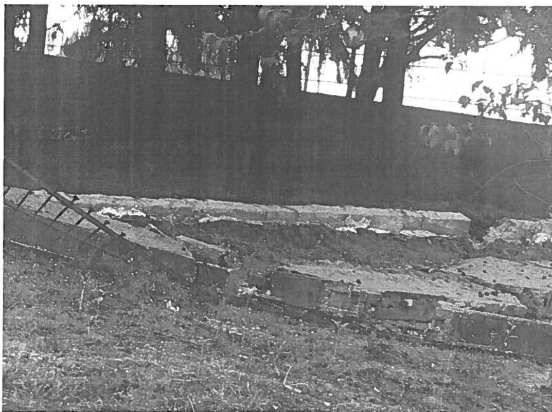
Εικόνα 20: Κατάρρευση περίφραξης Κοιμητηρίων Ταγαράδων
