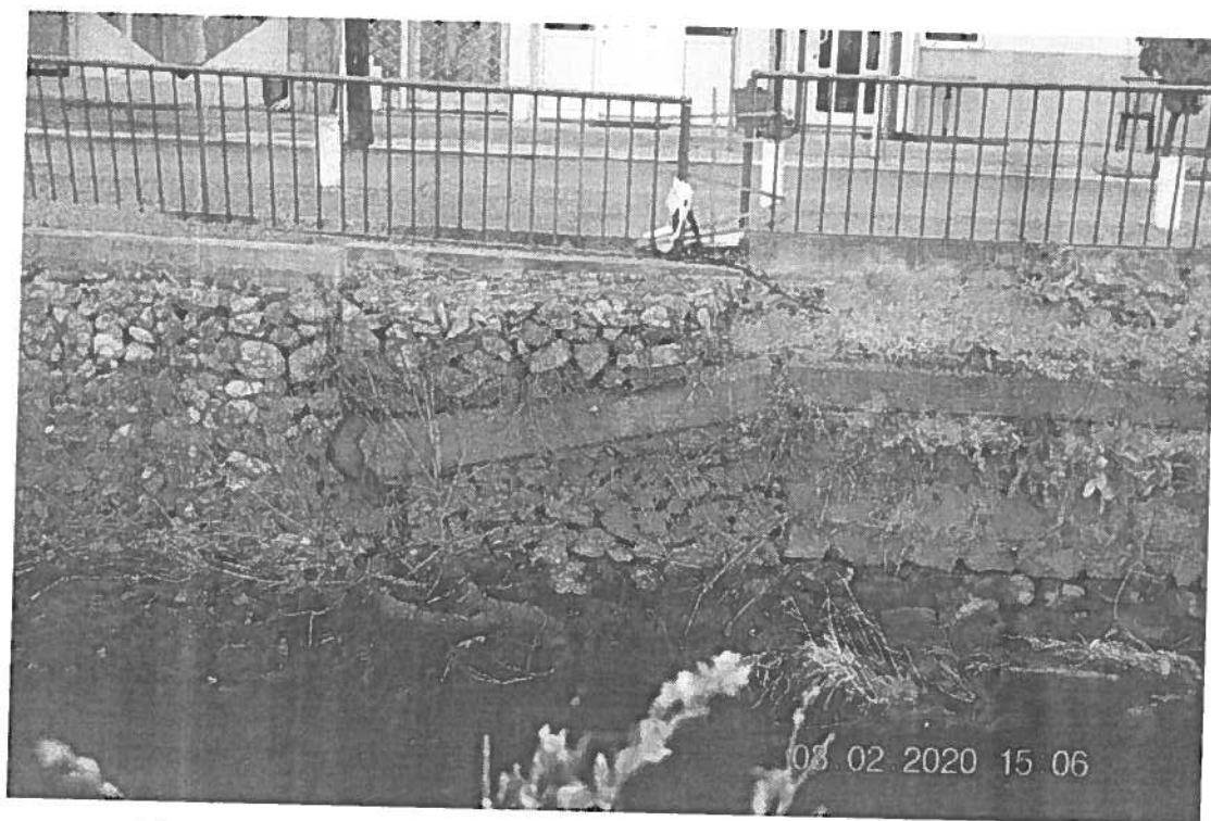
Φωτ. 14 / Θραύση στοιχείου σκυροδέματος, καθίζηση πρανών
