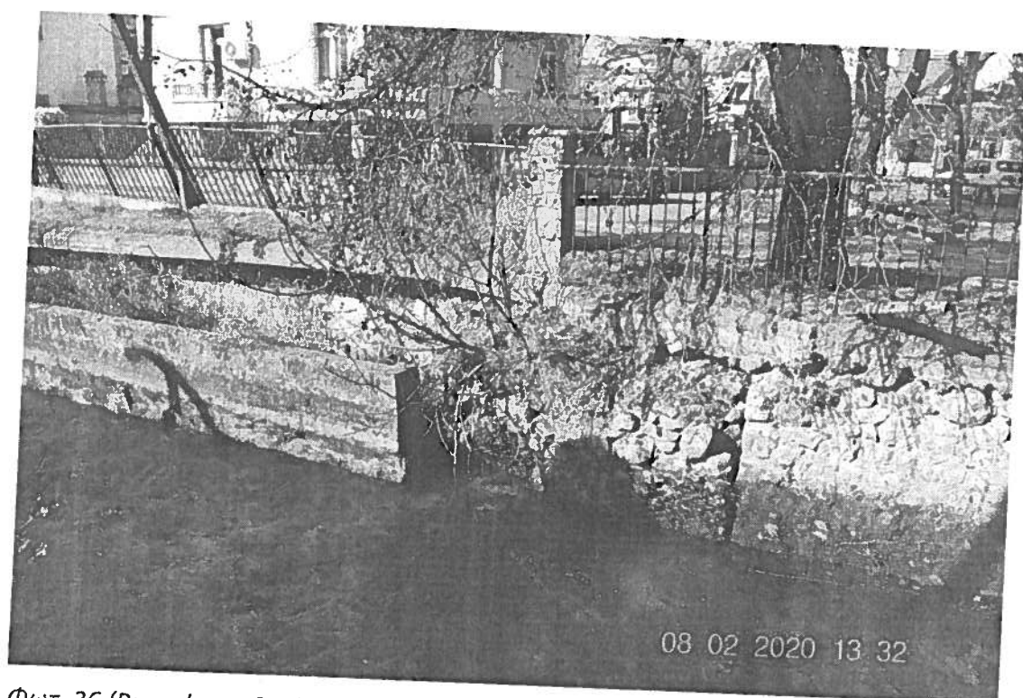
Φωτ. 36 (Ρωγμώσεις ξερή άναρχη βλάστηση)
