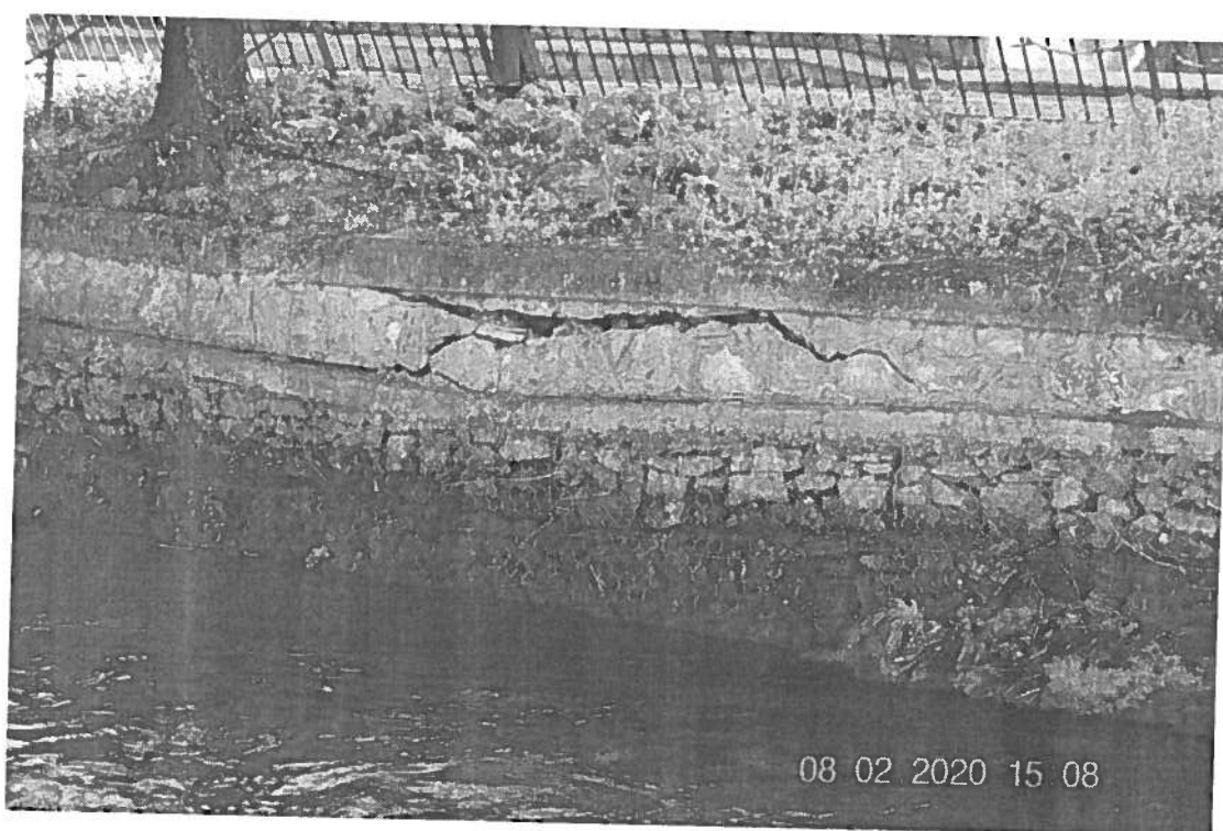
Φωτ. 15 / Θραύση στοιχείου σκυροδέματος
