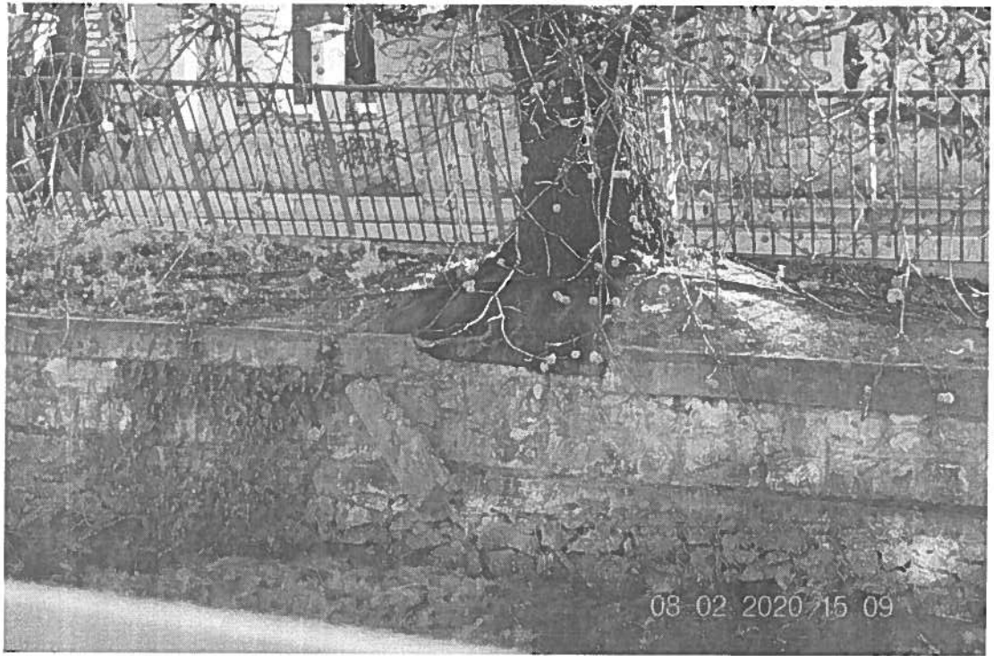
Φωτ. 39 (Επικίνδυνο δέντρο)
