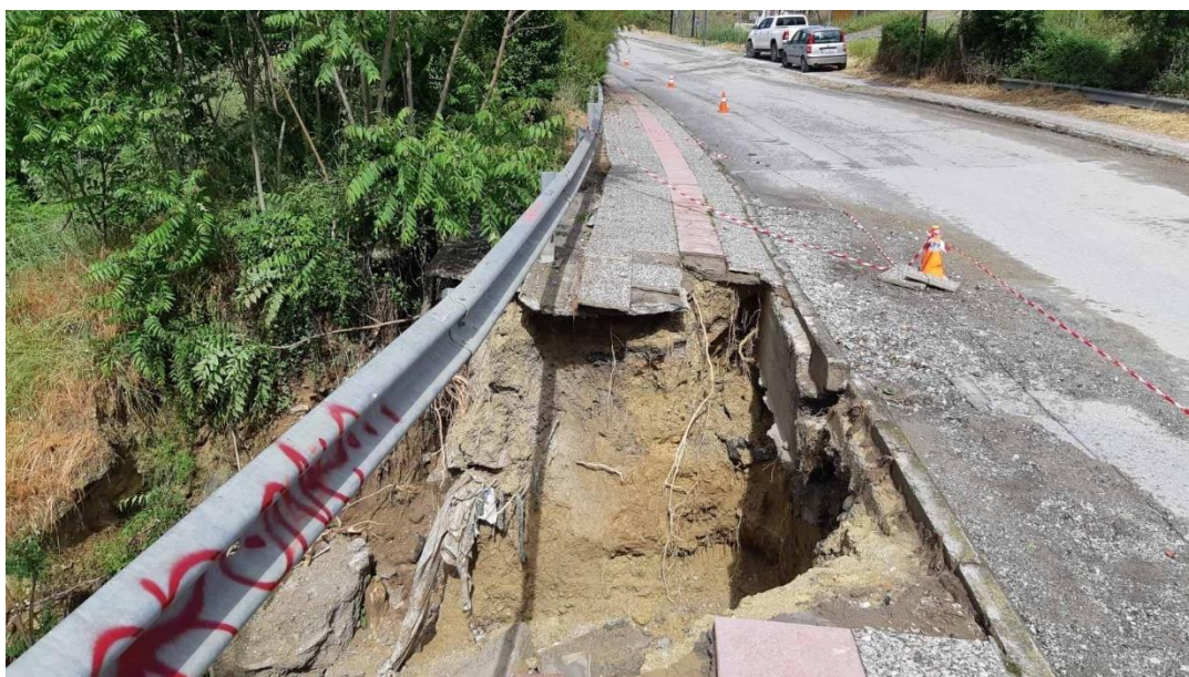
Εικόνα 2.1.4. Αποτυπώνεται η αστοχία επί του καταστρώματος της οδού Περικλέους, όπου έχει καταστραφεί το πεζοδρόμιο σε όλο το πλάτος του για μήκος περί τα 6,0-7,0μ., ο εγκιβωτισμένος αγωγός απορροής των ομβρίων και τοπικά το ανάντη τμήμα του επιχώματος έδρασης.
