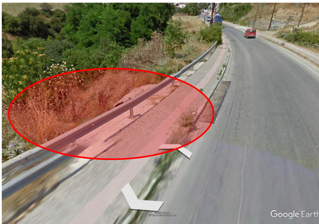
Εικόνα 2.1.3. Αποτύπωση θέσης αστοχίας με χρήση Google Earth (ημερομηνία εικόνας 7/2011). Παρουσιάζεται το υφιστάμενο τεχνικό έργο συλλογής και απορροής των ομβρίων στο χαμηλότερο μηκοτομικά σημείο της οδού και προς το ανάντη (σε σχέση με την ροή του ρέματος) πρανές του επιχώματος.
