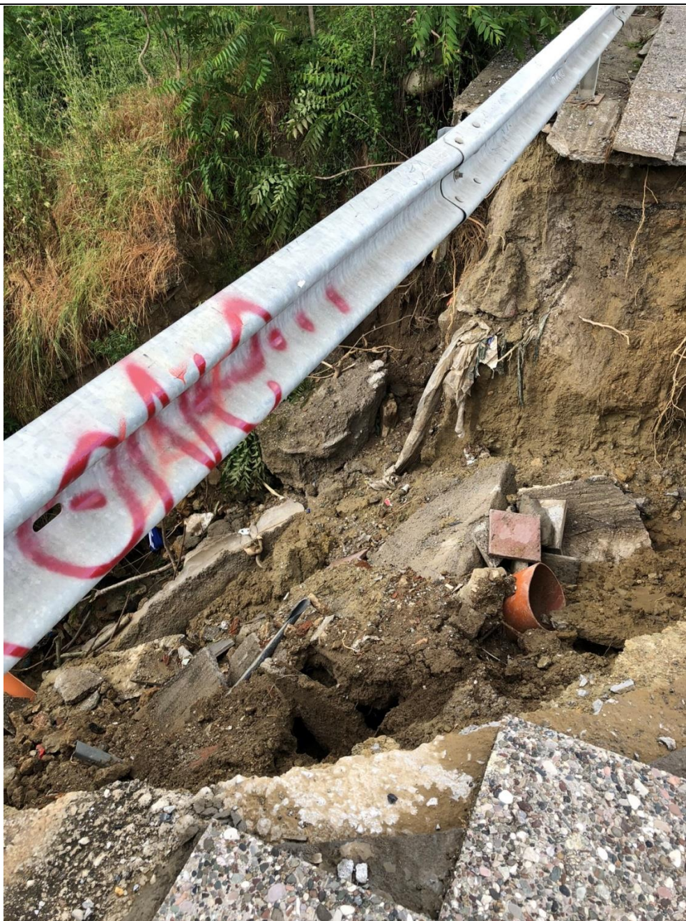
Εικόνα 2.1.6. Αποτυπώνεται η αστοχία επί του καταστρώματος της οδού Περικλέους, όπου έχει καταστραφεί το πεζοδρόμιο σε όλο το πλάτος του για μήκος περί τα 6,0-7,0μ., ο εγκιβωτισμένος αγωγός απορροής των ομβρίων και τοπικά το ανάντη τμήμα του επιχώματος έδρασης.
