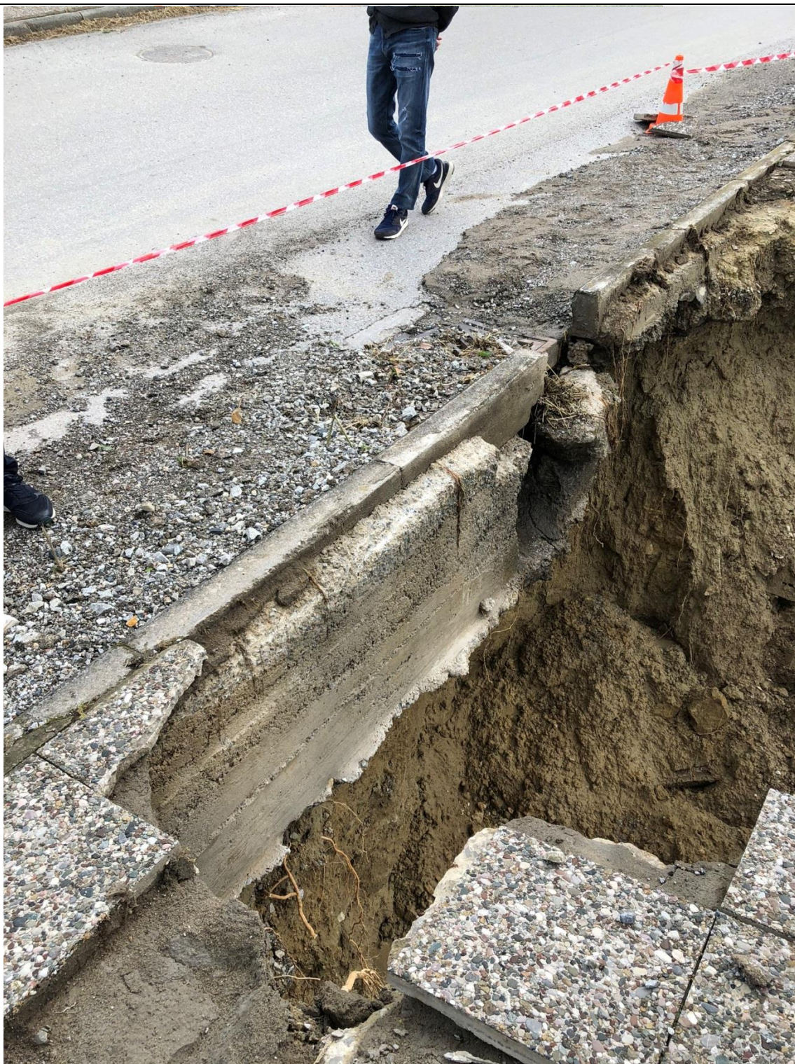
Εικόνα 2.1.5. Αποτυπώνεται η αστοχία επί του καταστρώματος της οδούς Περικλέους, όπου έχει καταστραφεί το πεζοδρόμιο σε όλο το πλάτος του για μήκος περί τα 6,0-7,0μ., ο εγκιβωτισμένος αγωγός απορροής των ομβρίων και τοπικά το ανάντη τμήμα του επιχώματος έδρασης.
