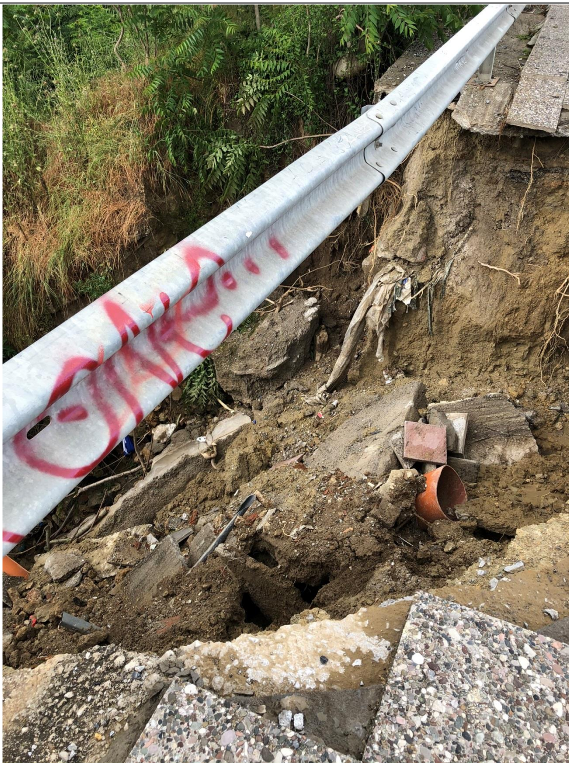
Εικόνα 2.1.7. Αποτυπώνονται κυρίως υλικά του αγωγού απορροής, τμήματος του καταστρώματος και πεζοδρομίου καθώς και του επιχώματος έδρασης, που έχουν αστοχήσει και κατολισθήσει σε τμήμα του ανάντη πρανούς.
