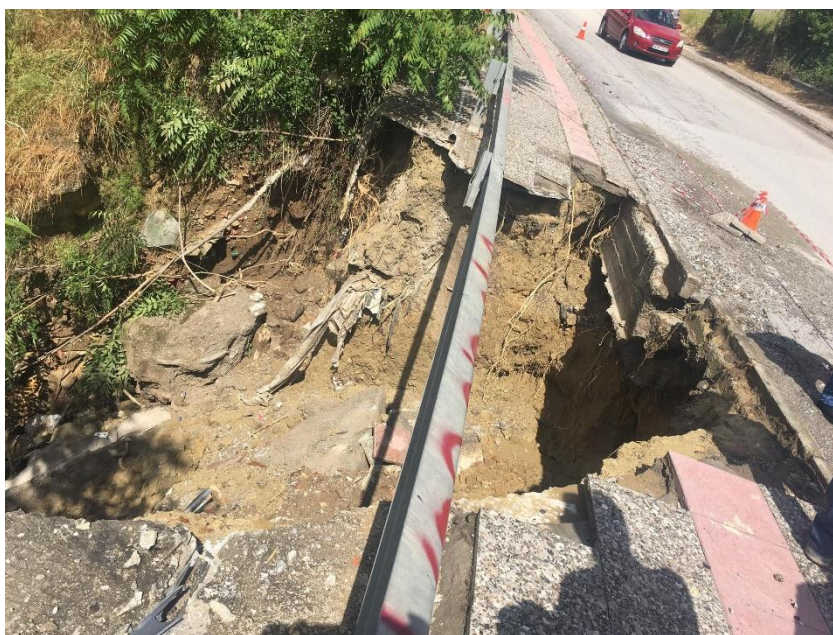
Εικόνα 2: Κατάρρευση πεζοδρομίου και τμήματος του οδοστρώματος εξαιτίας της κατολίσθησης
