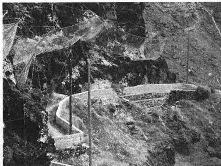
Εικόνα 12. Τοπική αστοχία του κατάντη τοίχου (Θέση 8)
