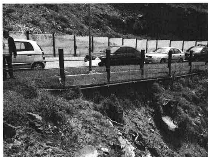
Εικόνα 8. Μικρής έκτασης υποσκαφή του δρόμου (Θέση 5)
