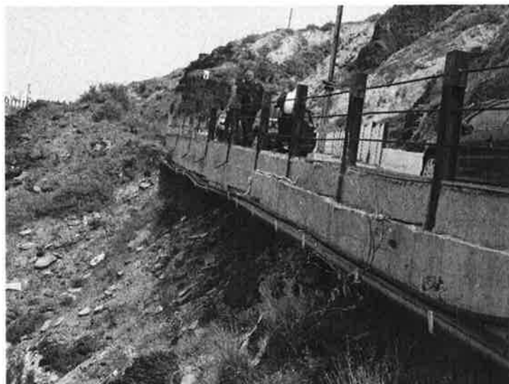
Εικόνα 7. Σημαντική υποσκαφή του δρόμου που απαιτεί τη λήψη μέτρων (Θέση 4)
