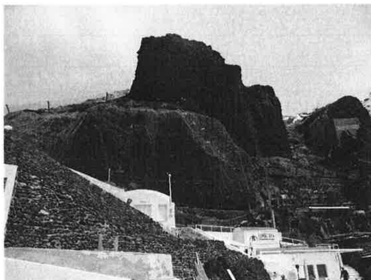
Εικόνα 10. Δυνητικά επισφαλής όγκος που ενδέχεται να αποκολληθεί (Θέση 7)
