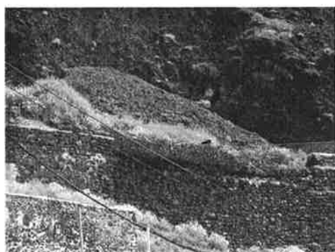
Εικόνα 15. Παραμόρφωση φράχτη ανάσχεσης βραχοπτώσεων λόγω μεγάλης συσσώρευσης υλικού (Όρμος Αμμουδίων)
