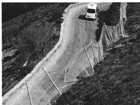
Εικόνα 13. Αστοχία ορθοστάτη λόγω πρόσκρουσης ογκολίθου (Δρόμος πρόσβασης προς Αθηνιό)
