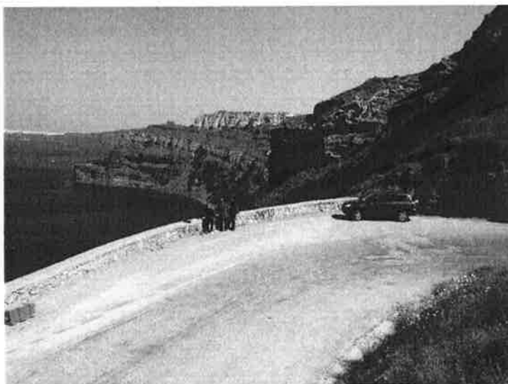
Εικόνα 4. Άποψη αστοχίας στη Θέση 2 από ανάντη
